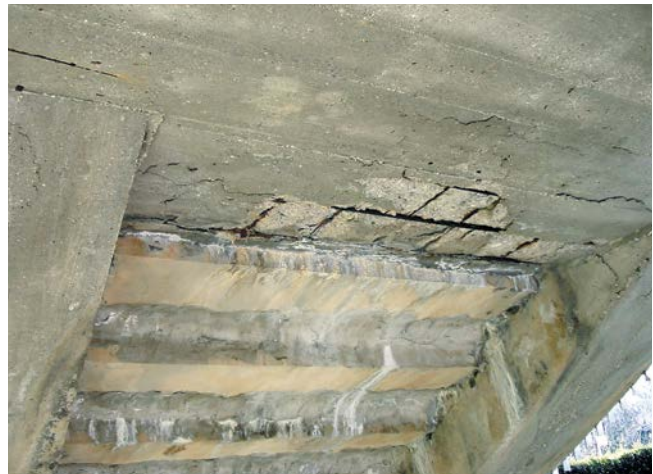
Corrosieschade aan de onderzijde van een trap door een missende afdichting en door een te geringe betonbedekking.
