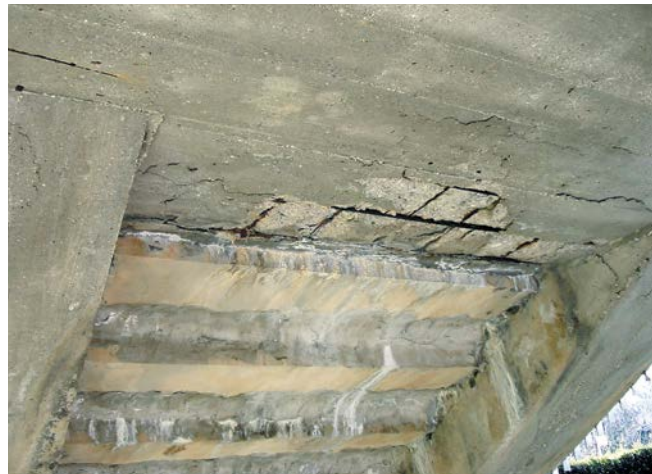
Corrosieschade aan de onderzijde van een trap door een missende afdichting en door een te geringe betonbedekking.
