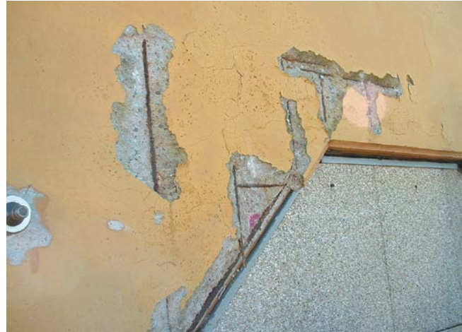
Barsten in een gevel vanwege een te geringe betondekking.
