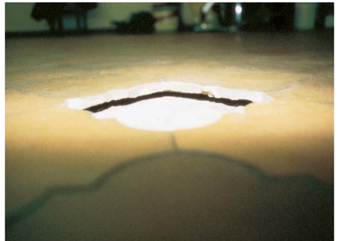
Hol liggende tegelafwerking.
