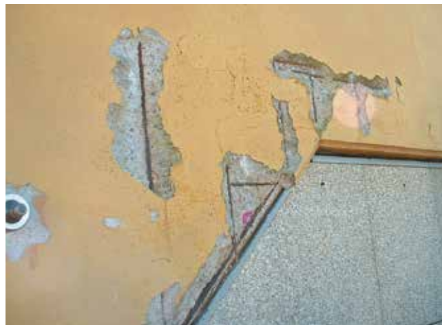
A túl vékony beton fedőréteg miatt lepattogott részek a homlokzaton.
