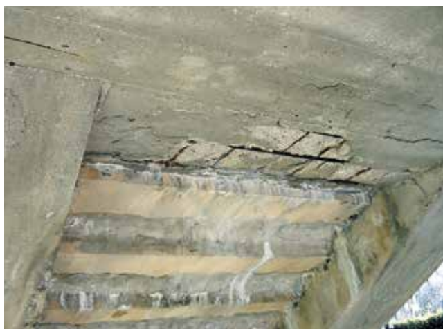
A szigetelés hiánya és a nem megfelelő vastagságú betonréteg miatt elindult korrózióképződés lépcsőfeljáróban.
