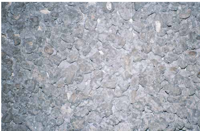
Chape ciment poreuse, à pores ouverts
