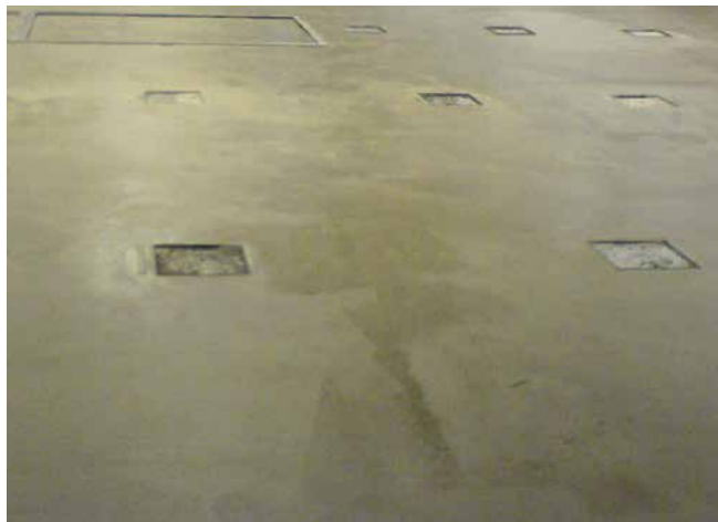
1 Sol traité avec le Ragréage autolissant Sopro FS 15® plus puis avec un primaire pour la pose, ensuite, d'un revêtement.
