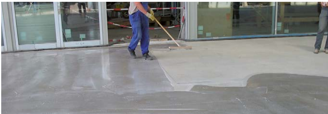
Leichtes Auftragen von Sopro MultiGrund zum Schutz des calciumsulfatgebundenen Estrichs gegen Durchfeuchtung.
