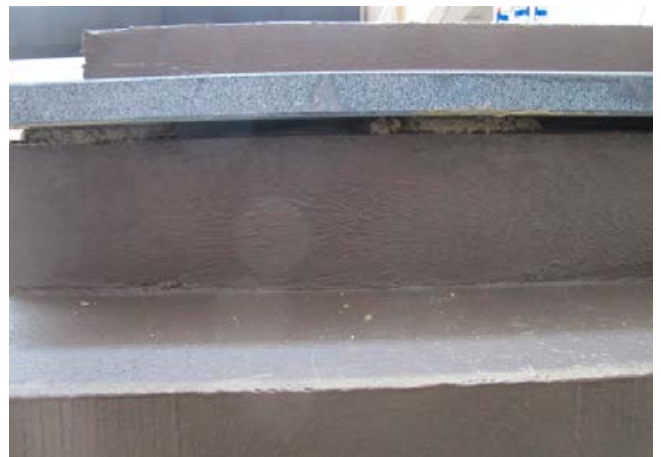
Gut sind die Mörtelstreifen unterhalb der Trittstufe erkennbar.
