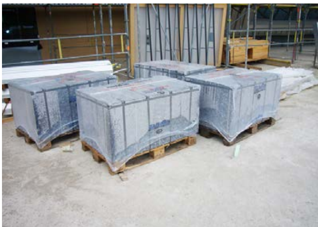
Platten, welche eingeschweißt auf der Baustelle unter der Folie schwitzen, sind in der Regel zu nass.
