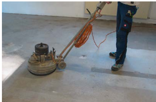
Schleifen von calciumsulfatgebundenen Estrichen als wichtige Vorbereitung für einen dauerhaften Verbund des Fliesenbelags.
