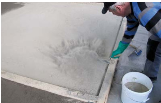
Die Pudertechnik ist generell eine kritische Verarbeitungstechnik , bei Großformaten nicht zu empfehlen.
