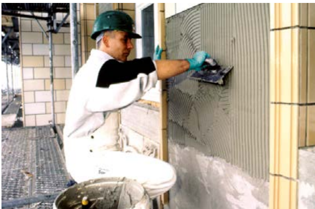
Kombiniertes Verfahren Untergrund.
