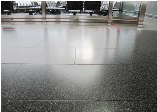
Geschüsselter und zum Teil gerissener Belag aufgrund falscher Mörtelwahl.
