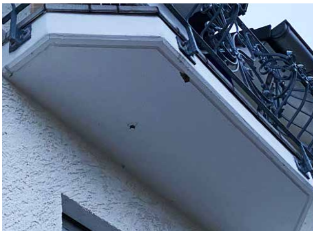
Abplatzungen am Balkon.
