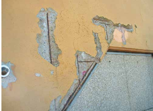
Abplatzungen an einer Fassade aufgrund zu geringer Betonüberdeckung.
