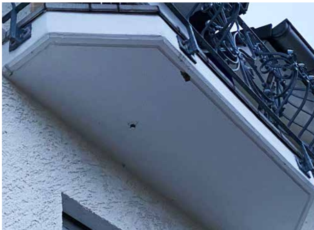
Abplatzungen am Balkon.
