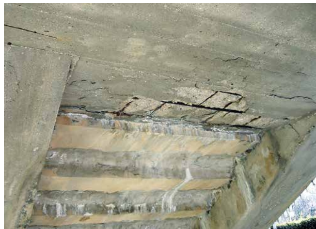
Unterseitige Korrosionsschäden an einem Treppenlauf durch eine fehlende Abdichtung und durch zu geringe Betonüberdeckung.
