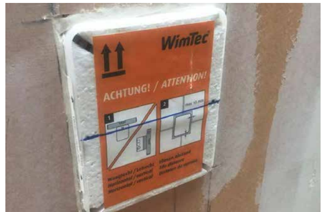
An dieser Armatur ist ein Abdichten nicht möglich. Das führt auf der Baustelle zu Problemen und ggf. auch in der späteren Nutzung.
