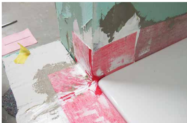
4 Anschluss einer Duschwanne oberkantenbündig an einem Fliesenbelag im Bereich einer Wandecke mittels zwei ineinander geschachtelter Sopro WannendichtMultiecke.
