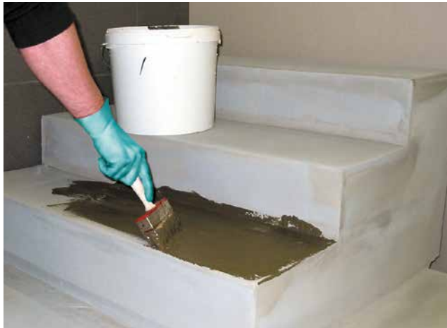
2 Auftragen der Sopro HaftSchlämme Flex auf der Verbundabdichtung als Kontaktschicht für den Sopro DrainageMörtel eXtra.
