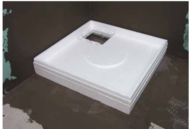
Der Wannenträger (System Kaldewei) wird in der Duschecke auf dem abgedichteten Untergrund aufgestellt.
