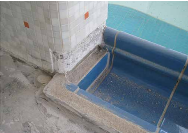
Kapillardichter Verguss am Ende einer Wiesbadener Rinne.
