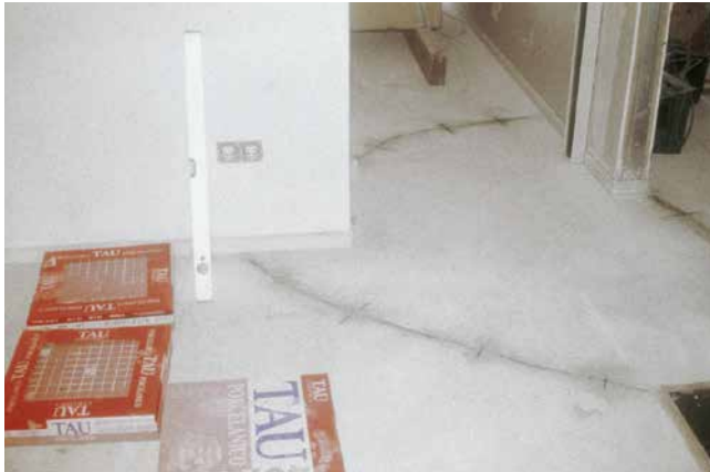
Eine Rissbildung bei calciumsulfatgebundenen Estrichen nach dem Trocknen ist immer wieder im Flurbereich zu beobachten, wenn im Türdurchgang keine Estrichfeldtrennung erfolgte.
