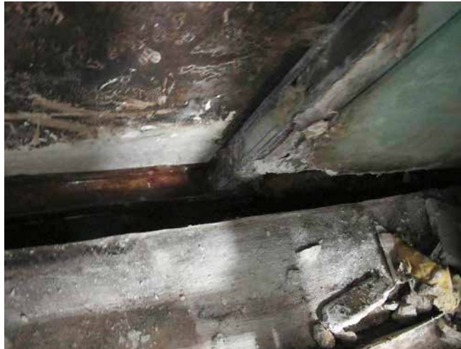
Schimmelbefall in einer Trockenbaukonstruktion mit Gipskarton.
