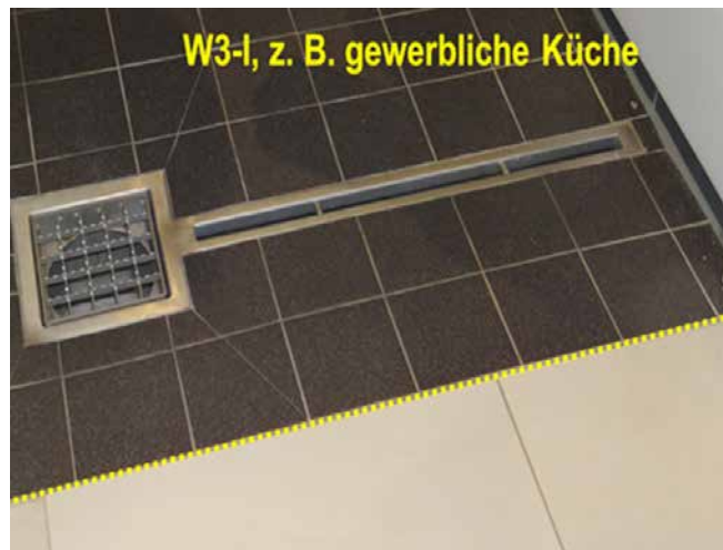
Eingebaute Schlitzrinne vor einem Türdurchgang im Bereich einer Großküche.
