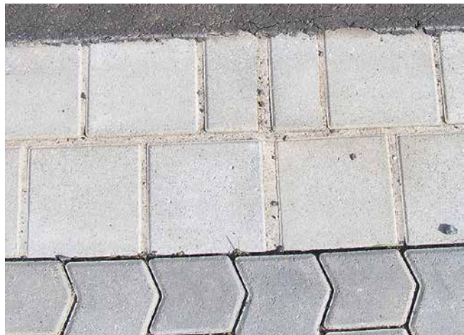
Zugefugte Bewegungsfuge, eine Spannungsableitung ist nicht möglich. Das gesamte Bauwerk kann dadurch Schaden nehmen.
