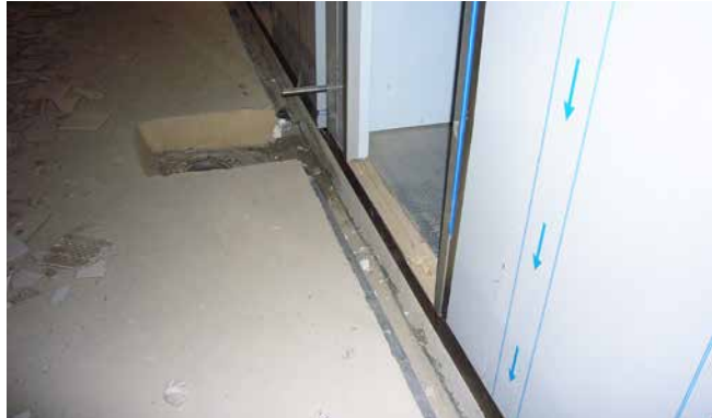
Kühlzelle in einer Großküche.
