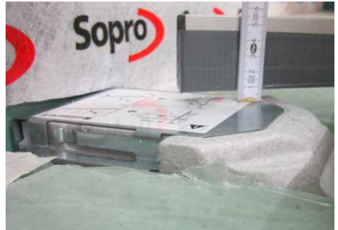
2 Die Estrichüberdeckungen sind partiell sehr dünn.
