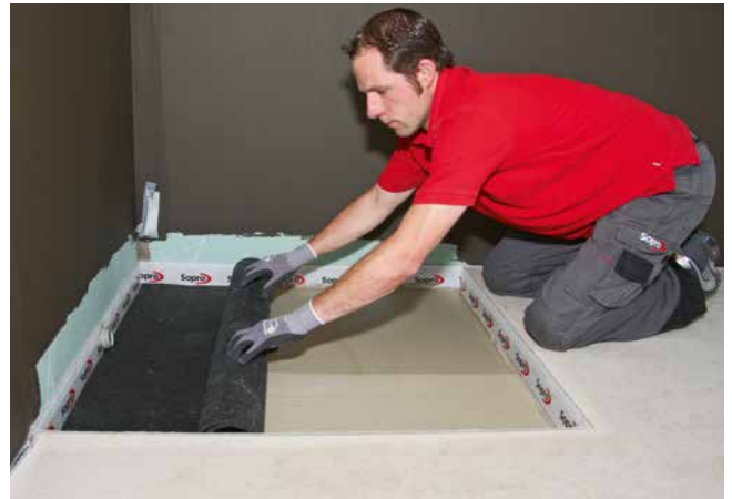
2 Verkleben einer Schallschutzbahn auf der planebenen Fläche mit Sopro's No.1 S1 Flexkleber.
