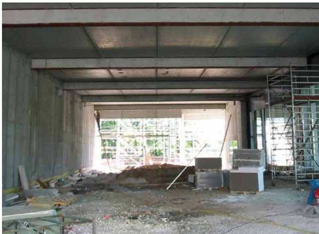
Überhöhte, vorgespannte Deckenkonstruktion, welche sich entspannt und sich im Mittelpunkt 2–4 cm absenken kann.
