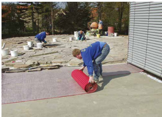
Ausrollen der Sopro DrainageMatte auf der abgedichteten Fläche mit anschließender Verlegung des Natursteins mit Sopro DrainageMörtel eXtra.
