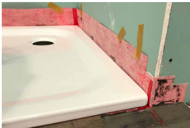
2 Anschluss einer hochstehenden Duschwanne an eine bündig endende Wandscheibe mittels Sopro WannendichtMultiecke und Sopro AEB®-Ecke.
