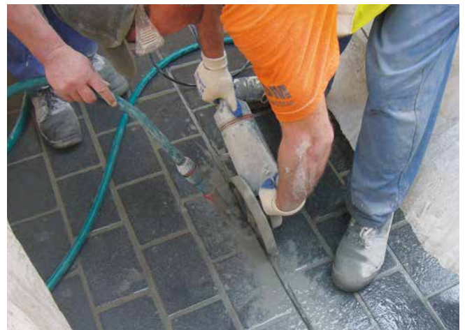
Einschneiden einer Bewegungsfuge in den Straßenbelag einige Tage nach dem Verlege- und Verfugungsprozess.
