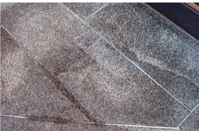
Verfärbungen eines Natursteins im Außenbereich durch Einwandern von Feuchtigkeit über die Fuge.
