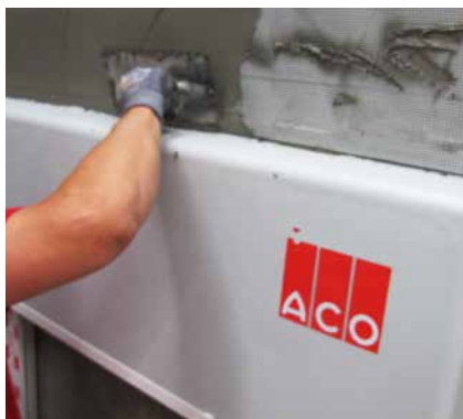
22 Der Rand des Dämmelementes wird mittels Sopro TurboDichtSchlämme 2-K oder Sopro ZR Turbo XXL und einer Einlage von Sopro Armierung dicht in die Abdichtung des Kellers integriert.
