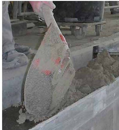
Einbringen des Estrichmörtels (Sopro Rapidur® M5) „frisch-in-frisch“ in die zuvor aufgetragene Sopro Epoxi-Grundierung.
