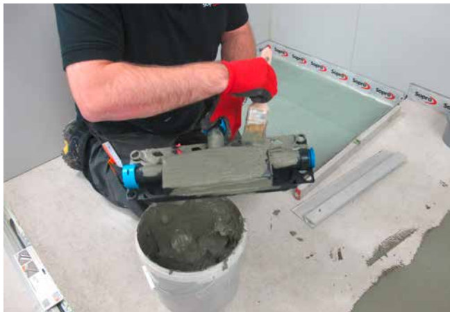
1 Einstreichen des Ablaufgehäuses mit einem Haftvermittler zur besseren Anbindung an den dünn-schichtigen Estrich.
