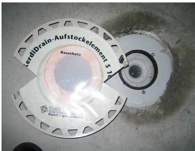
Aufstockelement mit breitem Klebeflansch für die Verbundabdichtung wurde zur einfacheren Montage (Verguss) aus Gedankenlosigkeit zerstört.
