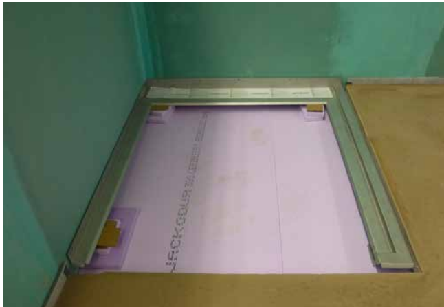
1 Rinnensystem mit Aufkantung und angeschlossener Schiene für die sichere und dichte Aufnahme einer Glasscheibe.
