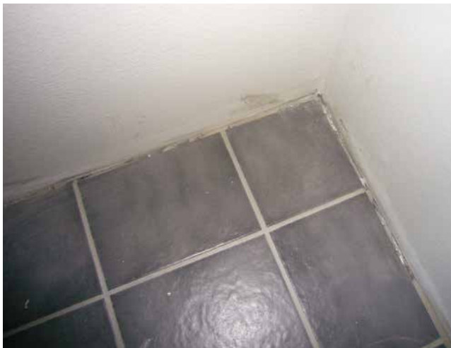
Wandkontakt des Klebers/Mörtels aufgrund fehlender Randdämmstreifen.
