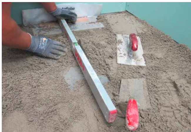
2 Einbau des Bodenablaufelementes in den Estrich mit Sopro Rapidur® M1/Sopro Rapidur® M5 mit entsprechendem Gefälle.
