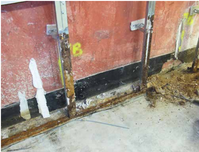
Zerstörung der Trockenbaukonstruktion, verursacht durch eingetragenes Wasser.
