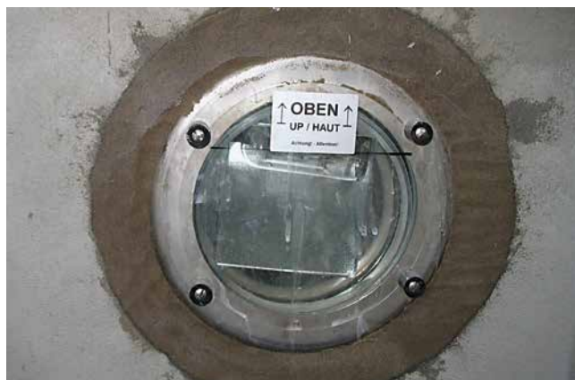
Scheinwerfergehäuse mit kapillarbrechender Spachtelung, hergestellt mit Sopro DünnBettEpoxi.
