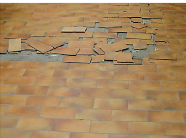
Haftverbundschaden aufgrund zu früher Belegung der Betonbodenplatte.
