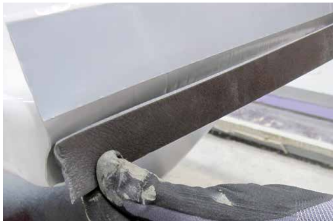
2 Ankleben eines Schaumstoffstreifens zur Vermeidung von Schallbrücken bei der Montage der Badewanne.
