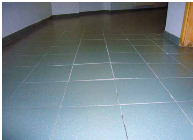
Gequollener Calciumsulfatestrich nach einem Wasserschaden.
