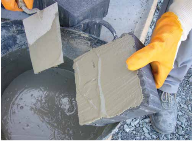
Auftragen der Haftbrücke (Sopro HaftSchlämme Flex) mittels Kelle auf der Rückseite des Steines.
