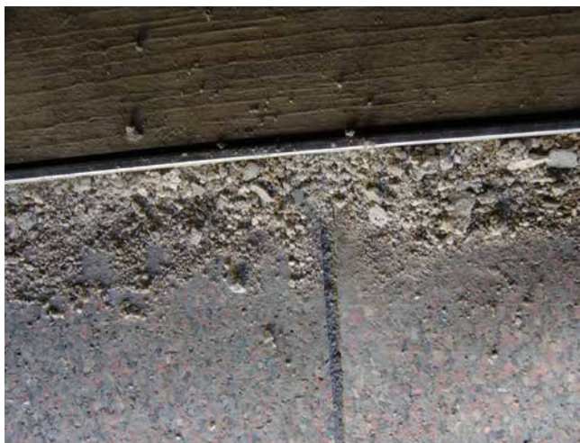
Kontakt aufgrund klaffender Fuge zwischen zwei Dämmplatten, welche mit Mörtel gefüllt ist.
