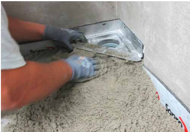
3 Im Bereich der Wand ist eine Aussparung vorzunehmen, damit das Eckentwässerungselement bündig mit der Wand und beweglich eingebaut werden kann.
