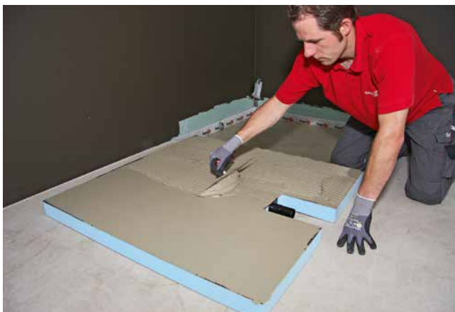
3 Auf der Rückseite des Duschelementes wird Fliesenkleber (Sopro's No.1 S1 Flexkleber) für die Verklebung zum Untergrund aufgetragen. Der Untergrund wird ebenfalls mit Fliesenkleber abgespachtelt.
