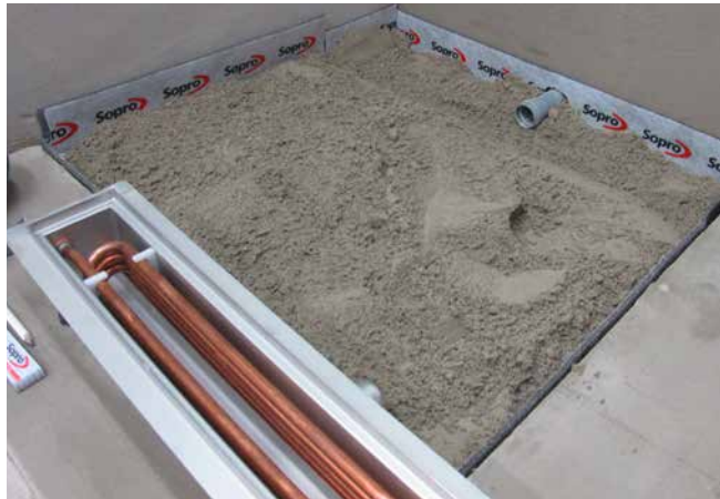
2 Versetzen der Rinne in den Zementestrich, hergestellt mit Sopro Rapidur® M1/Sopro Rapidur® M5.
