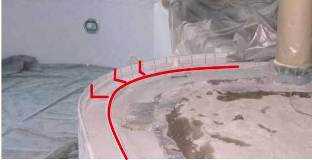
Nierenförmiges Becken mit schadhaftem Beckenkopf.
