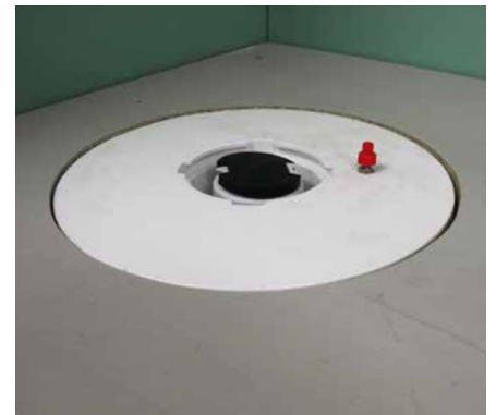
Entwässerungstopf für die Zwischenentwässerung unterhalb einer Badewanne.
