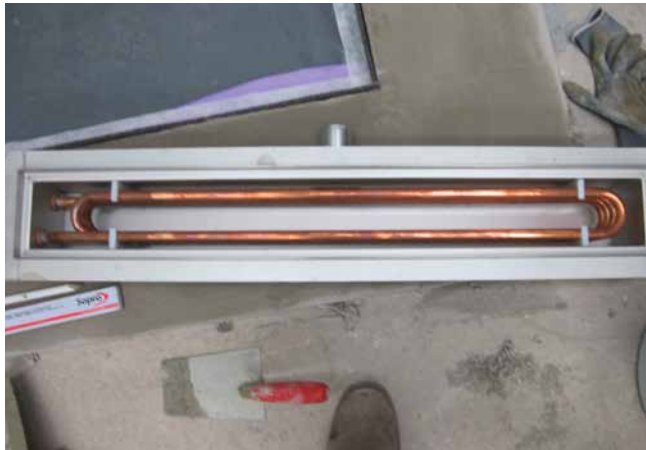
1 ACO Rinne mit Wärmetauscherkupferleitung zur Energieeinsparung. Über die Rinne findet eine Wärmerückgewinnung statt.
