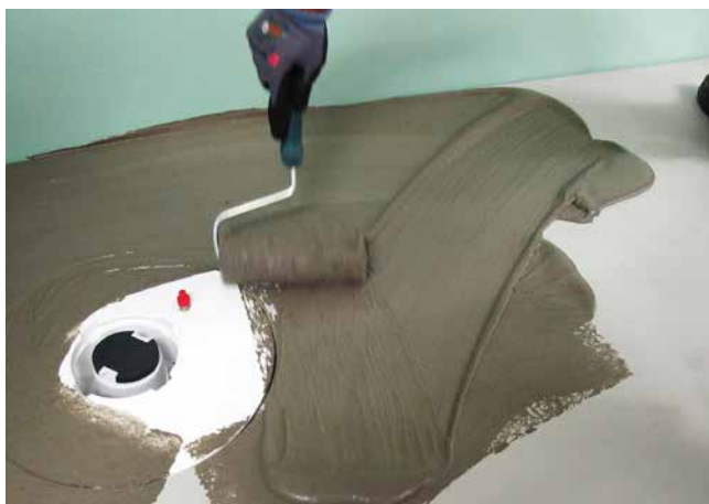
1 Verteilen des Sopro Fixier- und Dichtklebers auf dem Estrich und dem Flansch des Entwässerungsbauteils.
