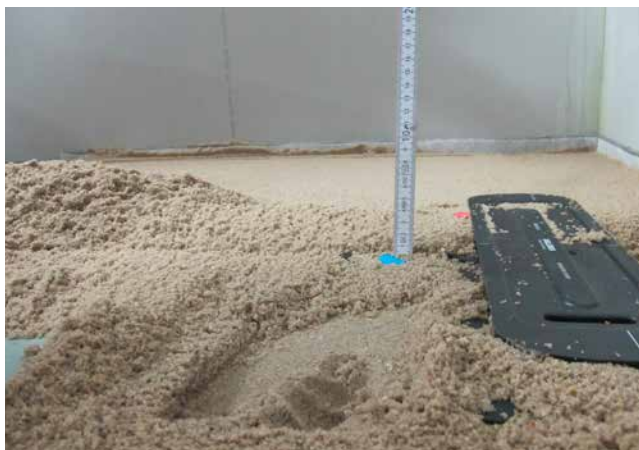
4 Die Dünnschichtigkeit über dem Ablauf ist mit dem harzgebundenen Mörtel lösbar.
