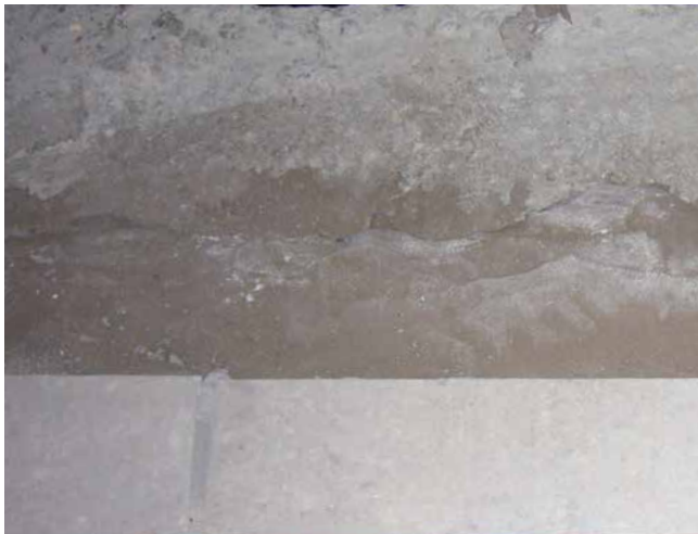
Schallbrücke, verursacht durch Verlegemörtel.
