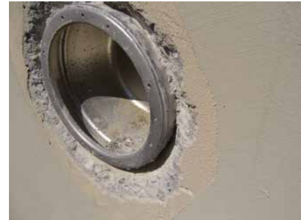
Freigestemmter Bereich am Scheinwerfer für eine kapillarbrechende Spachtelung (rohauseitig keine Vorkehrung getroffen).
