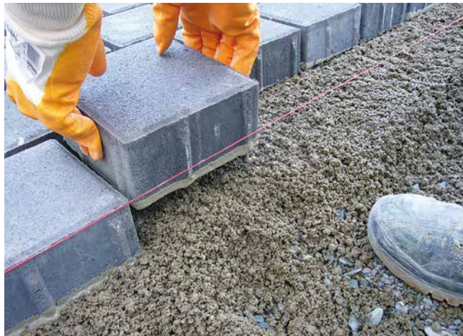
Versetzen des mit Haftbrücke vorbehandelten Steines „frisch-in-frisch“ in den vorbereiteten Bettungsmörtel Sopro DrainageMörtel.
