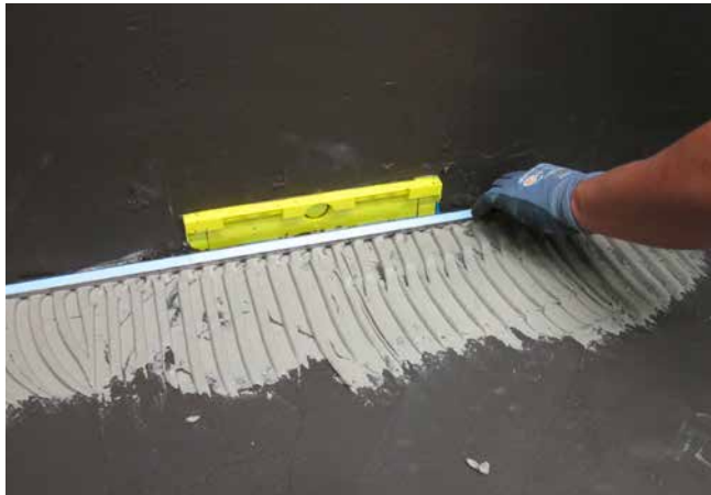
7 Vor dem Wandeinlaufelement wird eine Wassersammelschiene vollsatt mit Fliesenkleber (Sopro's No.1 S1 Flexkleber) auf der Verbundabdichtung verklebt.
