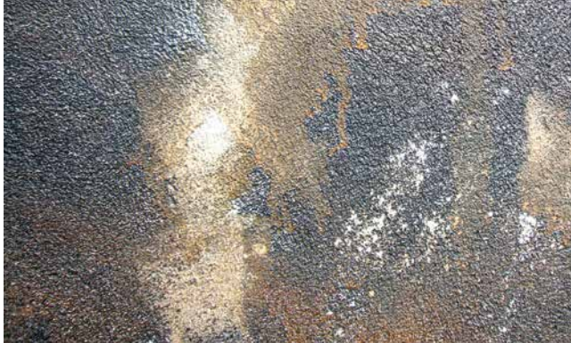
Alte freigelegte Kellerabdichtung.
