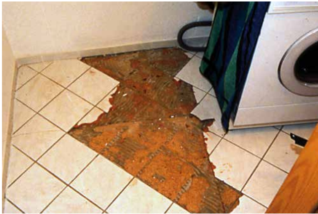
Rissbildung im Oberbelag im Bereich der Spanplattenstöße, verursacht durch Schwingung (z. B. Waschmaschine).
