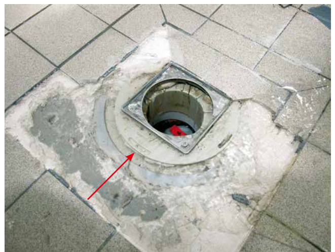
Werkseitig montierter Dichtflansch wurde, weil er störte, abgeschnitten. Die Folge: Keine Anschlussmöglichkeit zur Dichtungsschlämme mehr möglich.
