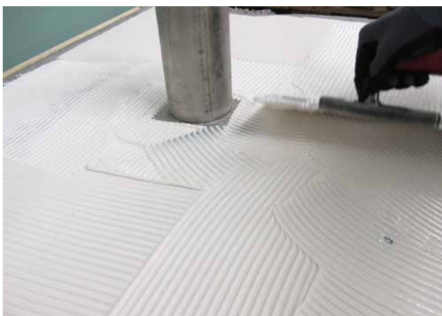
5 Das Hüllrohr wird nach den Grundierarbeiten mit Sopro Epoxi-Grundierung und der Quarzsandabstreuerung mit Sopro PU-FlächenDicht abgedichtet. Im Bereich der Durchdringung wird die Abdichtung durch eine Gewebeeinlage verstärkt.
