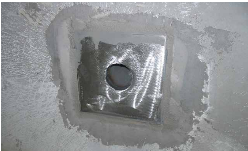
Flanschplatte mit geschlossener Hülse, eingelassen in das Becken für die Aufnahme eines Geländers.
