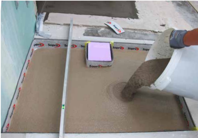
1 Herstellen einer planebenen Fläche mit Sopro Rapidur® FE Fließ-Estrich für die Aufnahme des Duschelementes.
