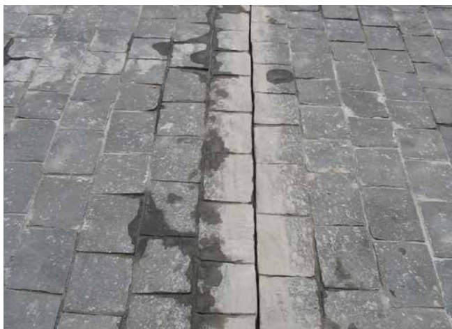
Mittels Winkelschleifer geöffnete Bewegungsfuge im Straßenbelag.
