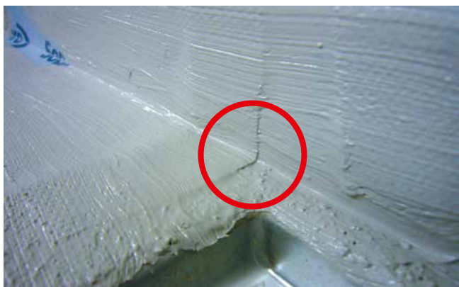
Dichtband liegt nach den Abdichtarbeiten press an – eine Kanalbildung und Hinterläufigkeit ist nicht gegeben.
