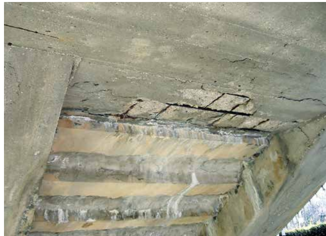
Unterseitige Korrosionsschäden an einem Treppenlauf durch eine fehlende Abdichtung und durch zu geringe Betonüberdeckung.
