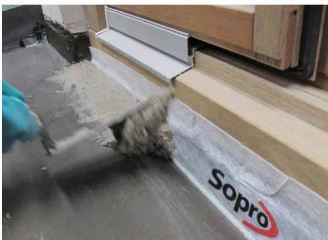
5 Nach dem Einstellen eines Randdämmstreifens wird die Vertiefung mit einem schwindarmen und kapillardichten Reaktionsharzmörtel verfüllt.
