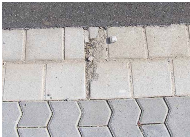
Ausbrüche an den Pflastersteinen.
