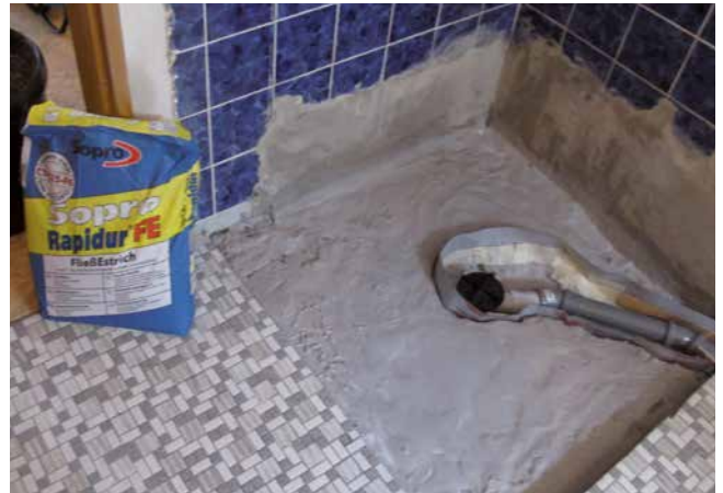
2 Herstellen einer planebenen Verlegefläche mit Sopro Rapidur® FE Fließestrich für die sichere, vollflächige Verlegung des Duschelementes.
