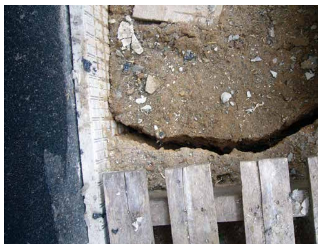
Große Setzungen aufgrund falscher Befüll- und Verdichtungsarbeiten. Wegen der fehlenden Gleitfolie ist eine Schädigung der Abdichtung vorprogrammiert.
