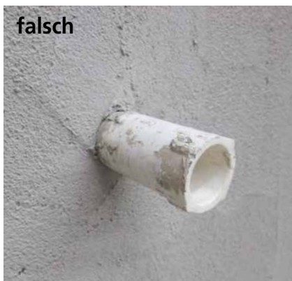
Eingeputzter Baustopfen, an welchem man nicht fachgerecht andichten kann.
