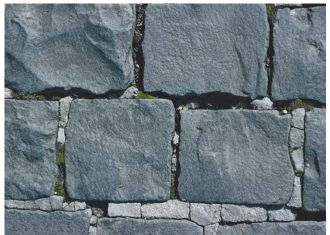
Zerstörte Fuge, verursacht durch die Kombination von hydraulisch gebundener Fuge mit ungebundenem Unterbau bei entsprechenden Verkehrslasten.
