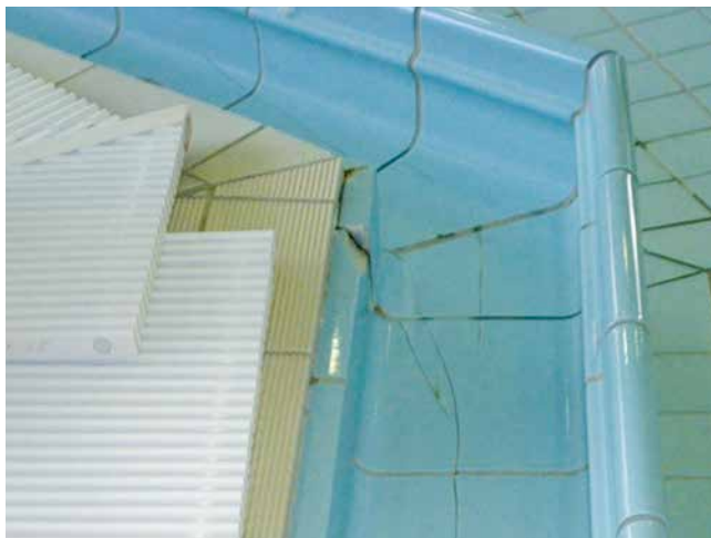
Gebrochene Rinnensteine an einer Innenecke aufgrund von Schubspannungen.
