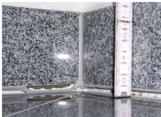
Silikonfugen werden bei Nichtbeachtung der Vorgaben durch die Verformungen im Estrich überdehnt und reißen ab.
