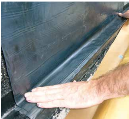
13 Schutzpapier vollständig entfernen und im Stoßbereich auf SoproThene® Klebeband (Verschweißungsband) überlappend verkleben.
