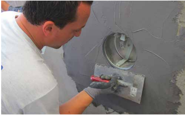
7 Abdichten der Fläche und des Scheinwerfers mit Sopro TurboDicht-Schlämme 2-K. Zur Verstärkung wird im Bereich des Scheinwerfers ein Armierungsgewebe in die Abdichtung mit eingearbeitet.
