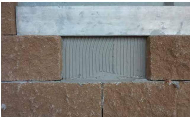
Ansetzen der Betonverblender auf dem Betonuntergrund mit Sopro FKM ® Silver im Buttering-Floating-Verfahren.
