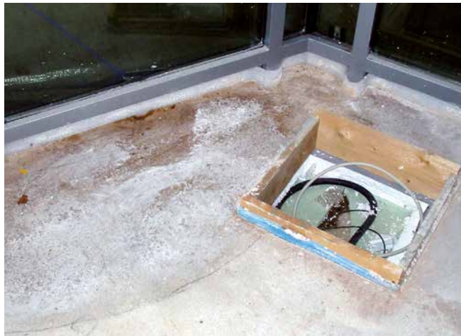
Festigkeitsprobleme und Auflösungserscheinungen des Calciumsulfatestrichs nach Wassereintritt.
