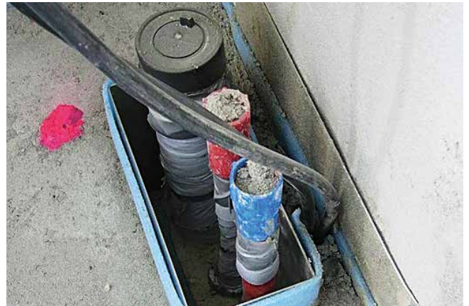
So nicht – Aufgrund des nicht vorhandenen Platzes ist auch kein fachgerechtes Eindichten möglich.
