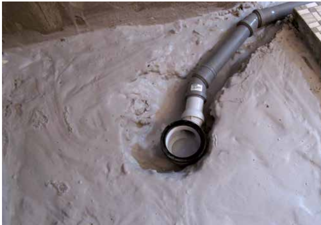
1 Ausgesparte, unebene Fläche mit Estrich auf einer Sanierungsbaustelle.
