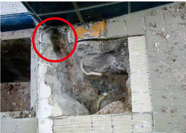
Unkontrollierter Wasserabfluss am Ende einer Rinne in die Beckenumgangsfläche.
