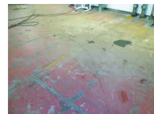
Stahlboden mit Schweißnähten, welche vor der Fliesenverlegung auszugleichen sind.
