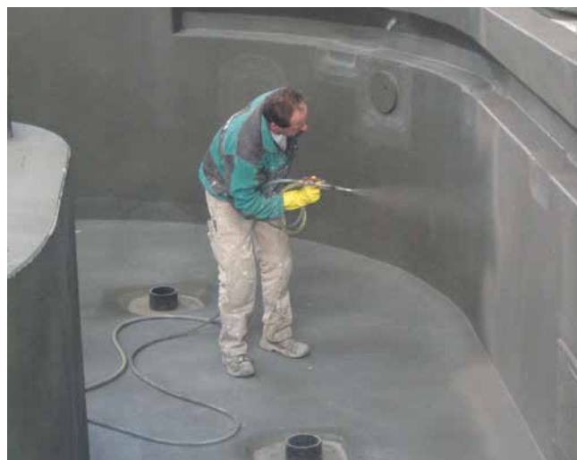
Abdichten eines Beckens im Spritzverfahren mit einer zementären flexiblen Dichtungsschlämme (z.B. Sopro DichtSchlämme Flex 2-K).
