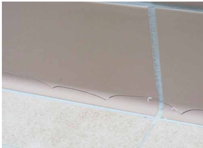
Hohlkehlsockelfliese mit dem langen Schenkel an der Wand verlegt, führt schnell zu Brüchen im unteren Bereich der Fliese.
