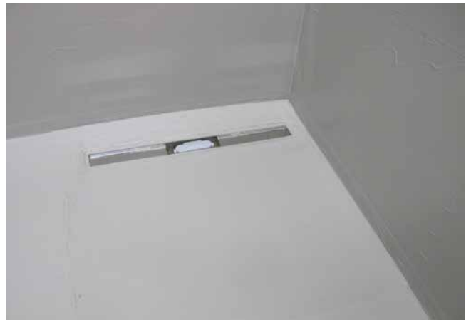
4 Fertig eingedichtete Rinne und abgedichtete Duschfläche mit der Flächenverbundabdichtung (Sopro DichtSchlämme Flex 1-K).
