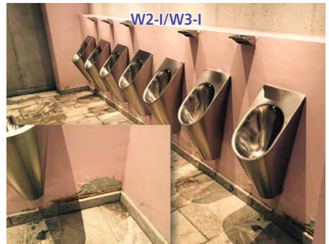
Die Toilettenanlage in einer Skihütte/einem Stadion hingegen ist aufgrund der sehr hohen Belastung bei W2-I bis W3-I festzulegen.
