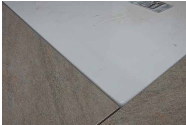
4 Gut erkennbar ist bei der Überprüfung der Höhen, dass der Fliesenbelag und die Duschfläche bündig zueinander sind.
