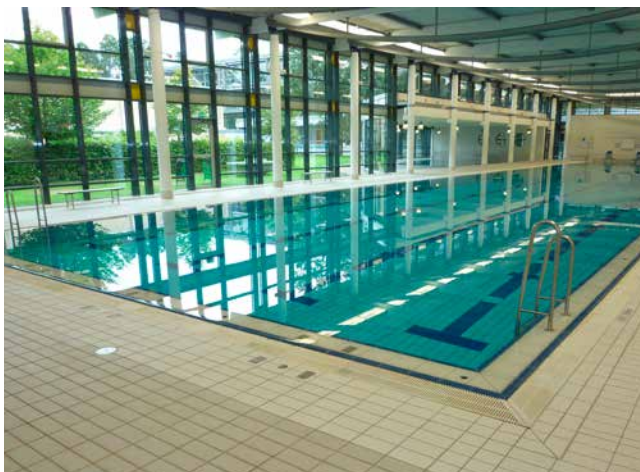
Hochfester, zementärer Fugenmörtel in der Kombination mit der üblichen Schwimmbadkeramik im Unterwasserbereich.
