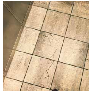
Gerissene Fliesen am Boden eines Aufzuges, bei welchem die auftretenden Verformungen nicht beachtet wurden.
