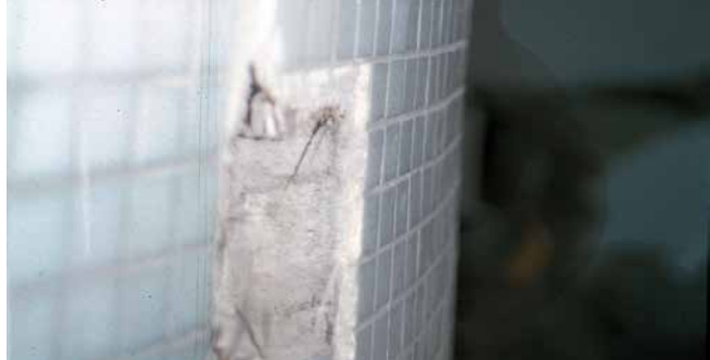
Verformte Glasmosaikwand, weil sich die Rinne vom Auflager schiebt.
