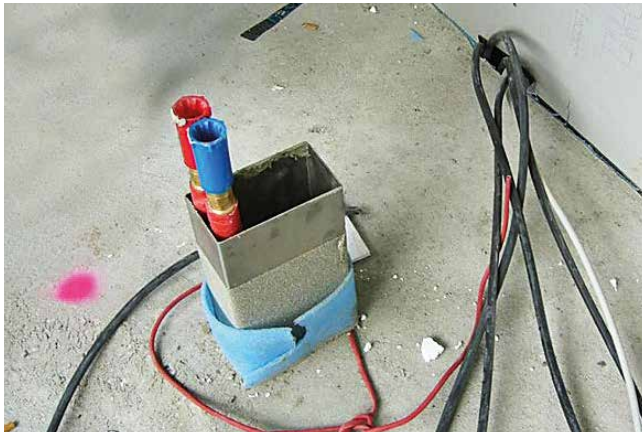
So nicht – Eine Leitung kommt unkontrolliert aus dem Estrich.
