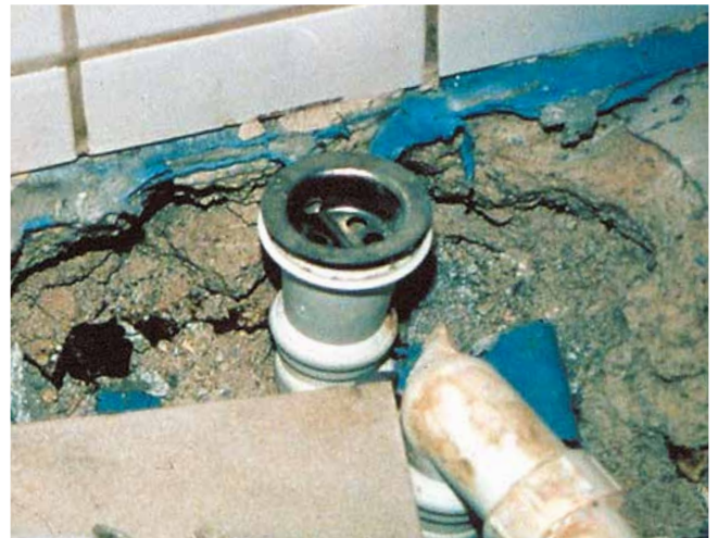
Undichtigkeit eines Tauchbeckens durch falschen Bodenablauf (Waschbeckenablauf). Flansch für den Anschluss der Abdichtung fehlt.
