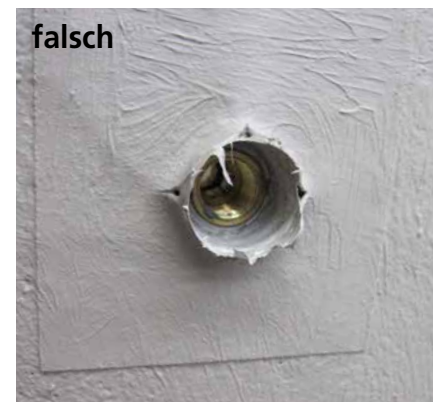
Nach dem Herausschrauben des Baustopfens für die folgende Installation hat die Dichtmanschette ihre abdichtende Wirkung völlig verloren.
