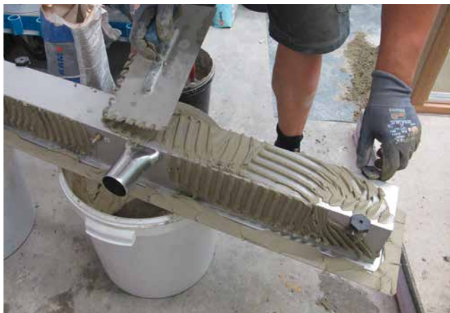
3 Für den besseren Haftverbund zum Estrich wird die Rinne vorher außenseitig mit Dünnbettmörtel abgespachtelt.
