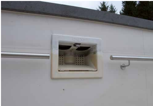
Schwimmbecken mit Skimmer.
