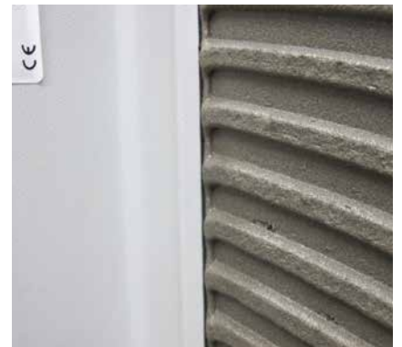
21 Die Elemente werden wasserdicht mit Sopro TurboDichtSchlämme 2-K oder Sopro ZR Turbo XXL an der Kelleraußenwand verklebt.
