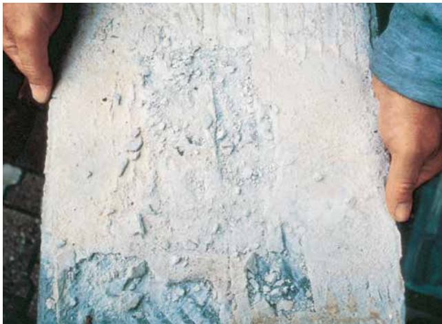
Haftverbundschaden durch Ettringitbildung.
