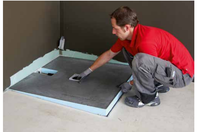
Die plattenförmige Abdichtung hat ihren Ursprung im Bereich des Duschboards.
