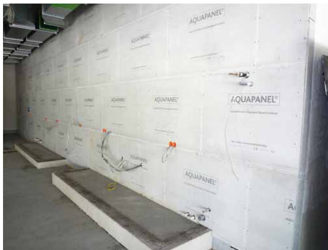
Zementgebundene Trockenbauplatten in einer Großküche.
