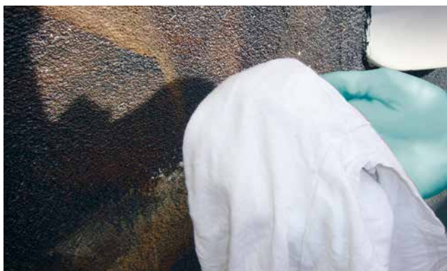
Keine Färbung: Ein Anlösen des alten Anstriches hat sich nicht gezeigt. Es handelt sich mit hoher Sicherheit um einen Teerpechanstrich.
