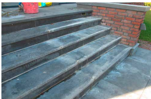
Terrassenflächen über eine Treppe entwässert. Verschmutzungen sind die Folge.
