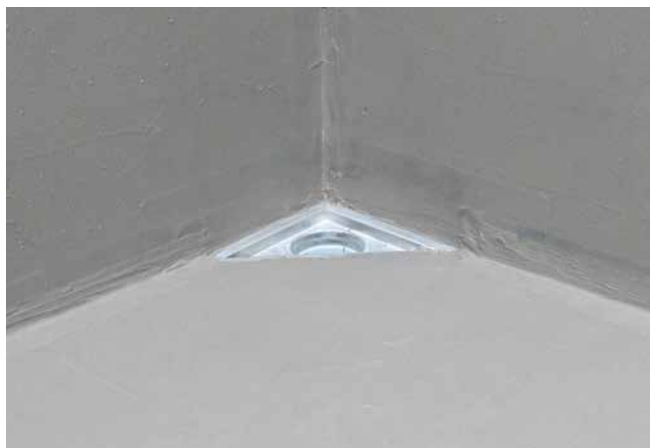
6 Abgedichtete Duschecke mit Sopro DichtSchlämme Flex 1-K oder wahlweise mit Sopro Turbo DichtSchlämme 2-K.
