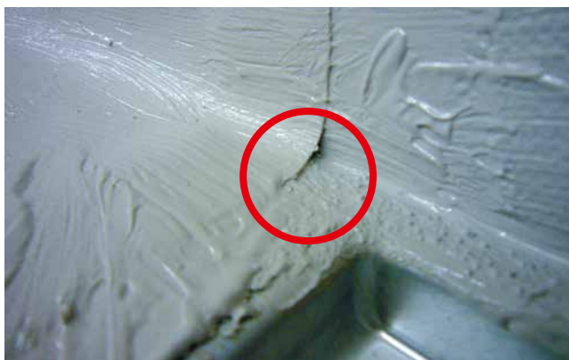
Eine Kanalbildung ist trotz Abdichtarbeit zu erkennen.
