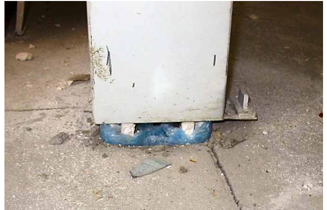
Ein Abdichten der Trockenbauwand ist im Türbereich nicht mehr fachgerecht möglich.
