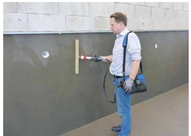
Mit dem elektrischen Messgerät lassen sich Fehlstellen schnell lokalisieren.
