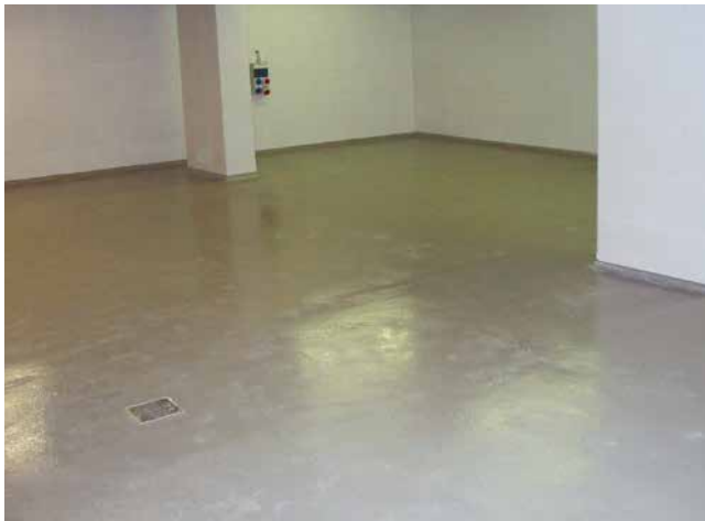
SoproDur® HF-L EpoxiLack hochfest Bodenbeschichtung in einem Müllraum in Kombination mit gefliesten Wänden.
