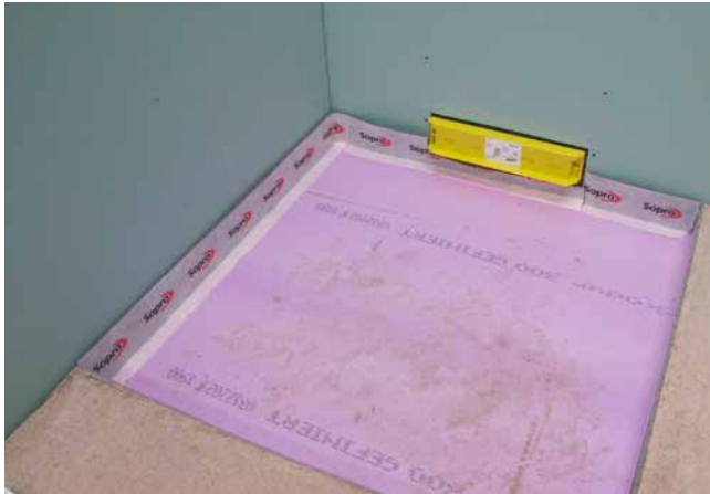
1 Wandeinlaufelement für Trockenbau- und Mauerwerkskonstruktionen (System Geberit) in Kombination mit schwimmender Estrichkonstruktion.
