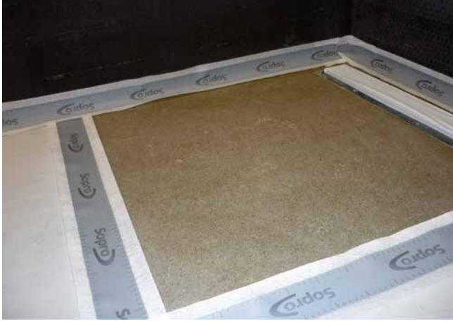
1 Vorbereiten der notwendigen Sopro Dichtbänder, welche in die Sopro DichtSchlämme Flex 1-K eingearbeitet werden sollen.
