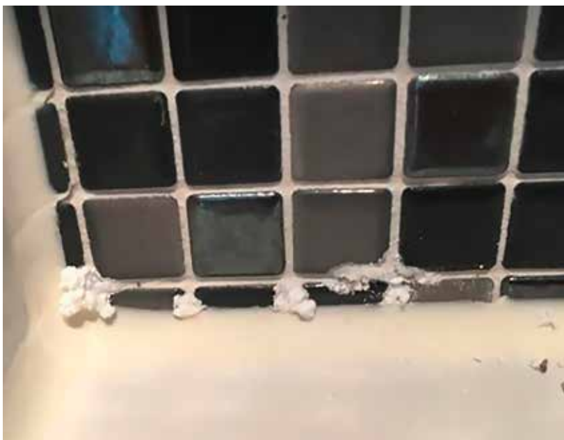
Ausblühungen an zementären Fugen aufgrund zu früh ausgeführter Silikonfugen
