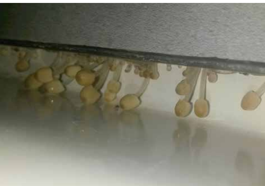
Pilzbildung im Bereich der Aufkantung einer Duschwanne
