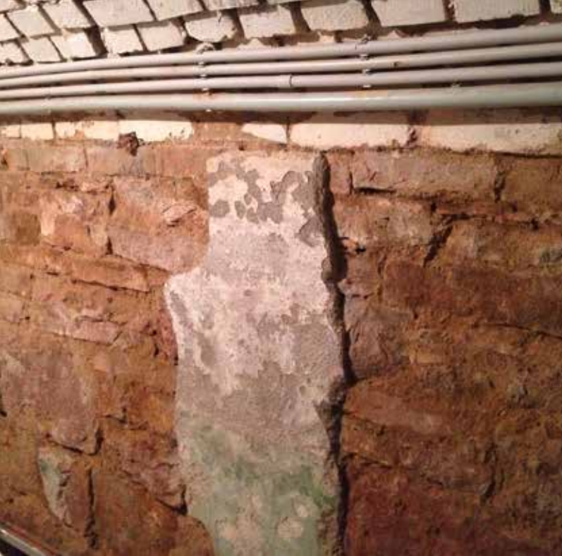
Feuchte Kellerwand mit Sanierungsbedarf
