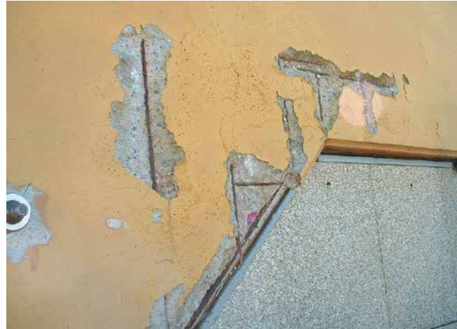
Abplatzungen an einer Fassade aufgrund zu geringer Betonüberdeckung.
