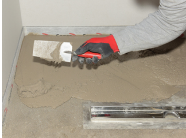
2. Herstellung eines Gefällespachtels durch Ausbreiten mit der Kelle auf der Fläche. Einbauen eines Gefälles bis max. 4 % möglich.
