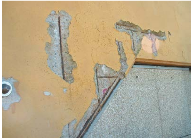
Abplatzungen an einer älteren Fassade aufgrund zu geringer Betonüberdeckung.
