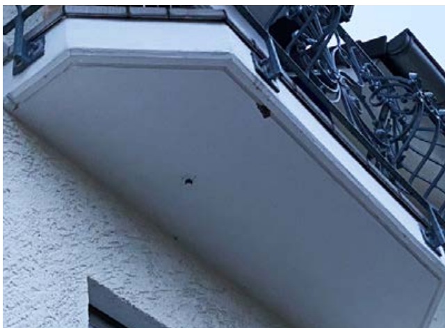
Abplatzungen am Balkon.
