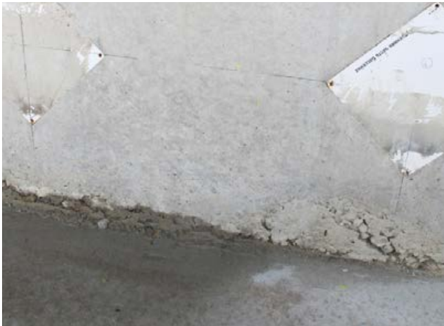
Kiesnester im Anschluss Wand-Boden.
