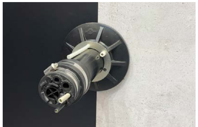
Die Wanddurchführung wurde zum späteren Zeitpunkt nachträglich eingedichtet.
