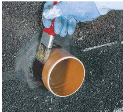
3 Um eine bessere Anhaftung der Bitumen-Dickbeschichtung an das Rohr zu gewährleisten, wird mit einem Pinsel Sopro KellerDichtGrundierung Konzentrat oder Sopro KellerDichtVoranstrich aufgetragen.
