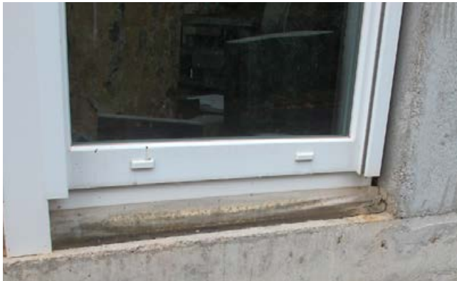
Bodengleiche Fenster mit Rolladenführungsschienen. Abdichtung?
