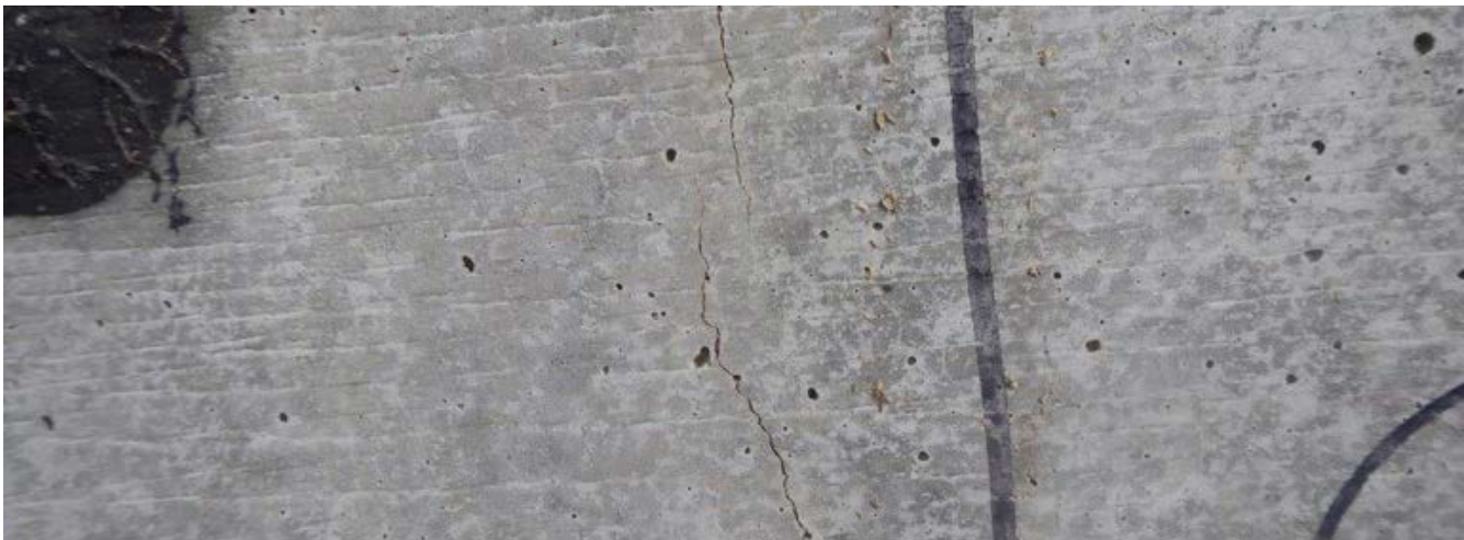
Rissbildungen in einer abzudichtenden Wand.
