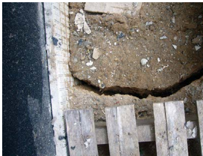
Große Setzungen aufgrund falscher Beifüll- und Verdichtungsarbeiten. Wegen der fehlenden Gleitfolie ist eine Schädigung der Abdichtung vorprogrammiert.
