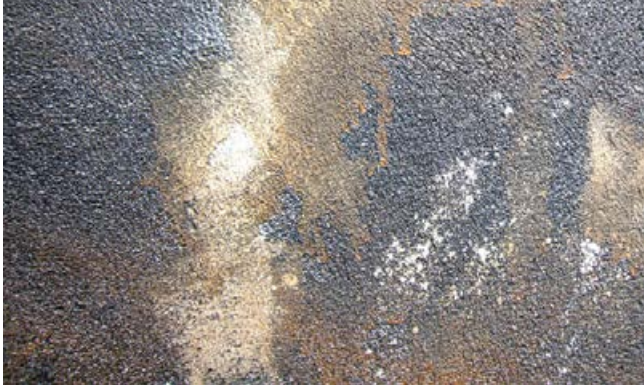
Alte freigelegte Kellerabdichtung.
