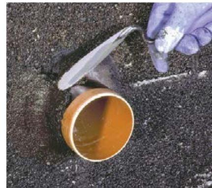
4 Nach Trocknung des Voranstriches bzw. der Grundierung wird das Rohr mit Sopro KellerDicht Super+ oder Sopro KellerDicht 2-K überzogen. Auch dieser Auftrag erfolgt in zwei Schichten.
