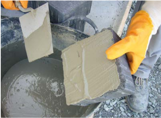
Auftragen der Haftbrücke (Sopro HaftSchlämme Flex) mittels Kelle auf der Rückseite des Steins.
