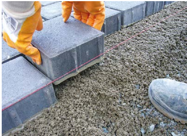
Versetzen des mit Haftbrücke vorbehandelten Steins „frisch-in-frisch“ in den vorbereiteten Bettungsmörtel Sopro DrainageMörtel.
