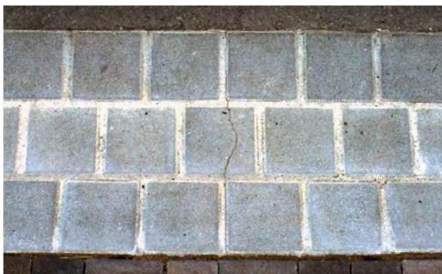
Bauwerke ohne Bewegungsfugen neigen zu Rissbildungen in den Pflastersteinen.
