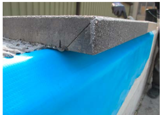
Die Platten (Rinn) werden mittels Sopro DünnBettEpoxi auf die Folie und den Beton verklebt. Die Folie wird auf den Beton mit Sopro PU-Kleber fixiert.
