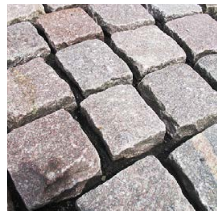
Die Fugen sind entleert und die Steinflanken sind frei von haftungsmindernden Stoffen.
