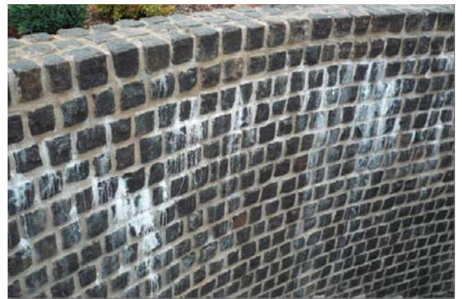
Wasser drückt durch die Mauer und führt zu erheblichen Ausblühungen.
