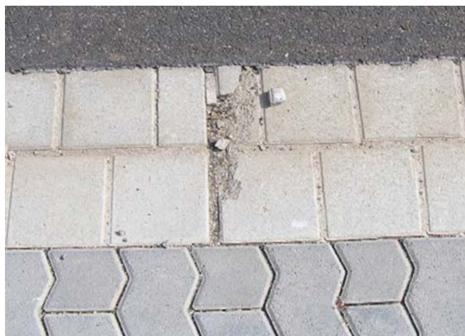
Ausbrüche an den Pflastersteinen.
