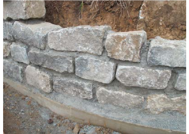
Große unterschiedliche Fugenbreiten ergeben sich.
