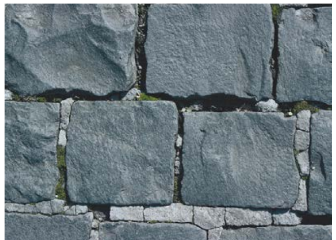
Zerstörte Fuge, verursacht durch die Kombination von hydraulisch gebundener Fuge mit ungebundenem Unterbau bei entsprechenden Verkehrslasten.
