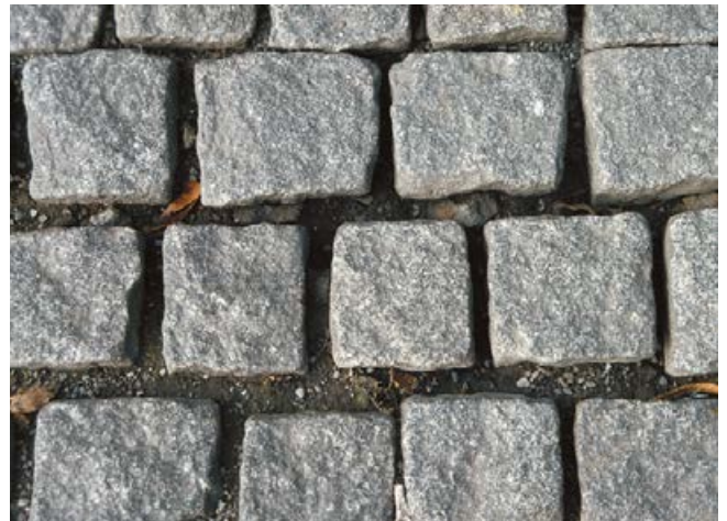
Herausgesaugte und herausgespülte Fugenfüllung durch Reinigungsprozess und Regenwasser.
