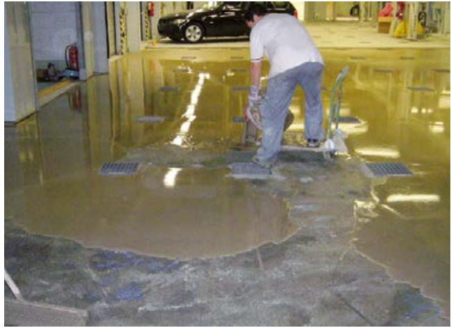
Einbau von Sopro FS 15® plus als vorbereitende Maßnahme für die folgende Verlegung von Großformatfliesen im Dünnbettverfahren.
