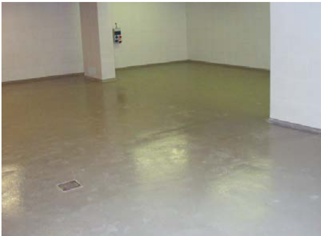
SoproDur® HF-L EpoxiLack hochfest Bodenbeschichtung in einem Müllraum in Kombination mit gefliesten Wänden.
