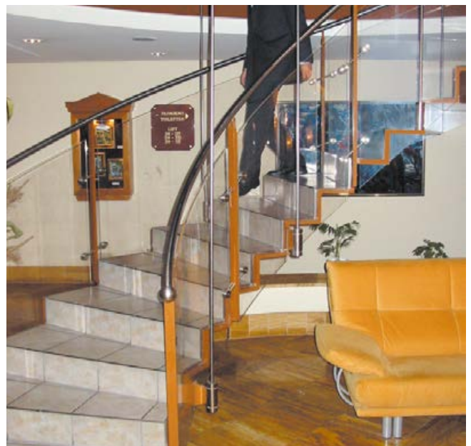
Aufgrund des Eigenschwungsverhaltens der Konstruktion ist eine hohe Spannungsaufnahme des Verlegemörtels erforderlich.
