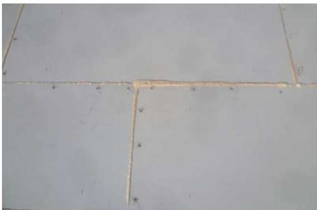
Fertig verlegter Trockenestrich. Herausquellender Kleber ist vor der folgenden Oberbodenverlegung zu entfernen.
