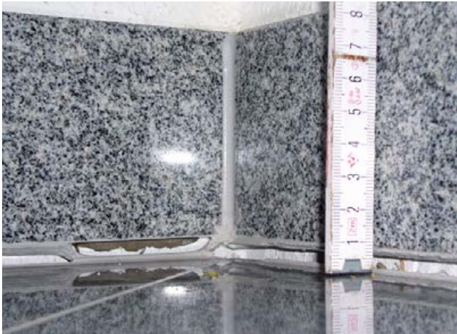
Silikonfugen werden bei Nichtbeachtung der Vorgaben durch die Verformungen im Estrich überdehnt und reißen ab.
