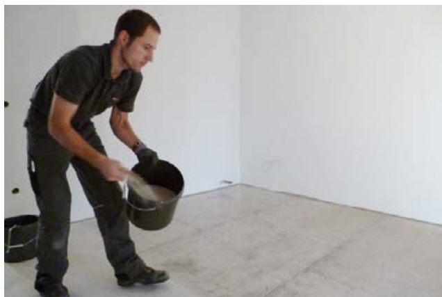
Abwerfen der frischen Grundierung mit Sopro Quarzsand. Der nicht eingebundene Überschuss ist spätestens vor der Oberbodenverlegung aufzunehmen.
