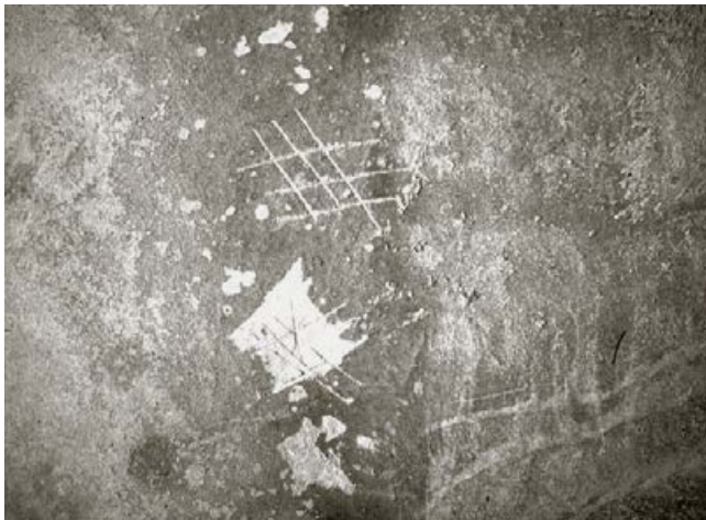
Überprüfung der Oberfläche auf Tragfähigkeit mittels Gitterritzprüfung, Abplatzungen sind gut erkennbar – hier muss angeschliffen werden.
