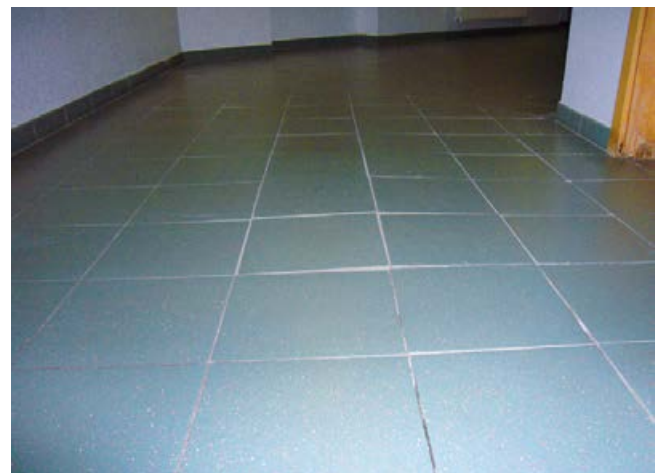
Gequollener Calciumsulfatestrich nach einem Wasserschaden.
