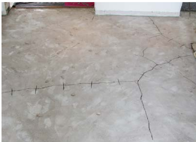
Nach Rückbau des Fliesenbelags sind die Risse im Estrich gut erkennbar. Diese sind zu bewerten und zu sanieren.
