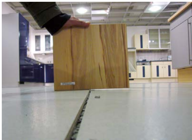
Verformung im Gussasphalt und keramischen Belag aufgrund von Temperatureinwirkung.
