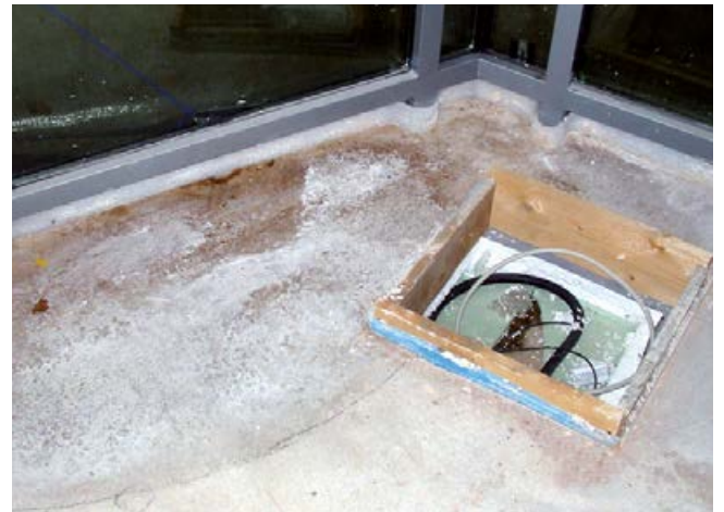
Festigkeitsprobleme und Auflösungserscheinungen des Calciumsulfatestrichs nach Wassereintritt.
