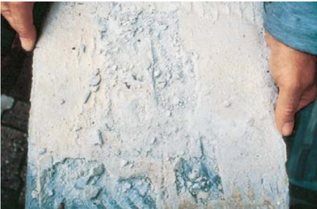
Haftverbundschaden durch Ettringitbildung.
