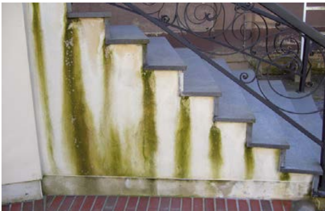
Seitlicher Austritt des Wassers führt zu Schäden und unschönen Verschmutzungen.
