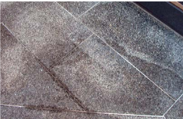
Verfärbungen eines Naturwerksteins im Außenbereich durch Einwandern von Feuchtigkeit über die Fuge und die Oberfläche.
