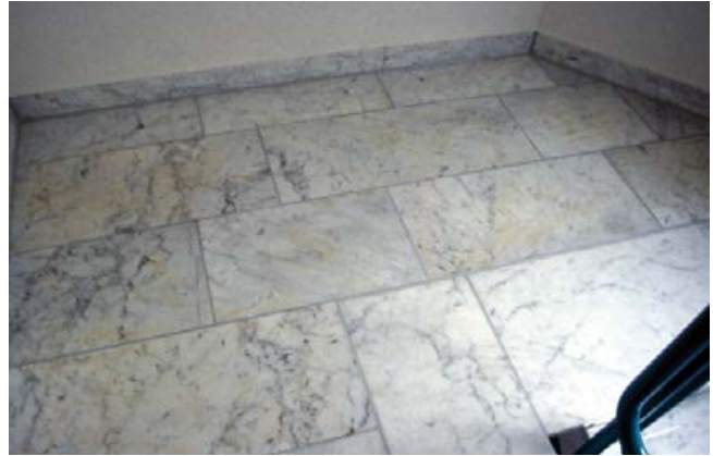
Gelbverfärbung des Naturwerksteins, hervorgerufen durch vorhandene Pyrite, welche sich durch das hohe Feuchtepotenzial des Dickbettmörtels farblich verändern.
