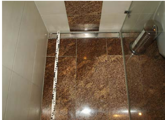
Dusche mit Randzonenverfärbungen im Naturwerkstein im Bereich der Rinne nach täglicher Nutzung.
