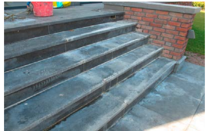
Terrassenflächen über eine Treppe entwässert. Verschmutzungen sind die Folge.
