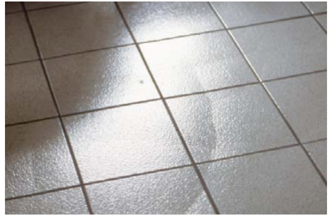
Rissbildung und Brüche in den Fliesen aufgrund direkter Verlegung auf Holzdielenboden.
