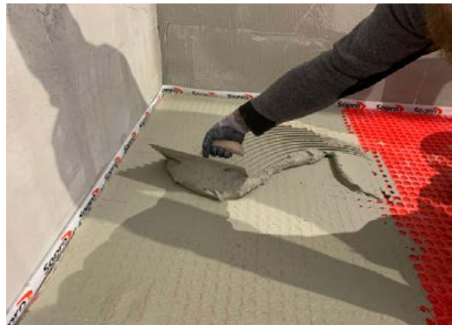
4 Die hinterschnittenen Vertiefungen der Bahn werden komplett mit Fliesenkleber zugespachtelt, anschließend wird für die Verlegung der Fliesenkleber in entsprechender Zahnung aufgekämmt.
