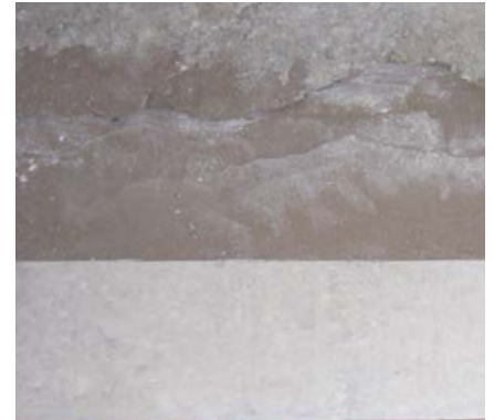
Schallbrücke, verursacht durch Verlegemörtel/ Mörtelbrücken.
