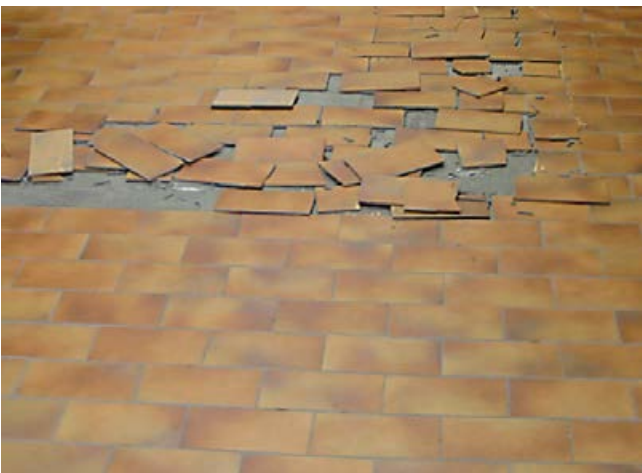
Haftverbundschaden aufgrund zu früher Belegung der Betonbodenplatte, einige Jahre später.
