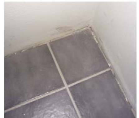
Wandkontakt des Klebers/Mörtels aufgrund fehlender Randdämmstreifen.
