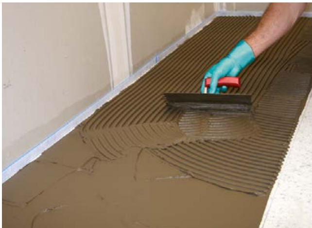
15 Auftragen des Fliesenklebers z. B. Sopro VarioFlex® XL auf der Sopro FliesenDämmplatte zur Verlegung des keramischen Belags.
