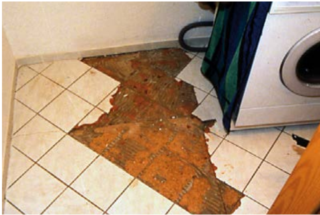
Rissbildung im Oberbelag im Bereich der Spanplattenstöße, verursacht durch Schwingung (z. B. Waschmaschine).
