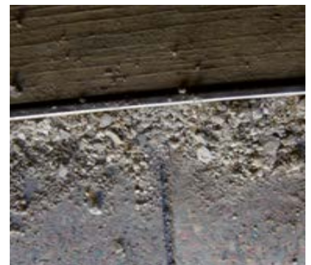
Kontakt aufgrund klaffender Fuge zwischen zwei Dämmplatten, welche mit Mörtel gefüllt ist.
