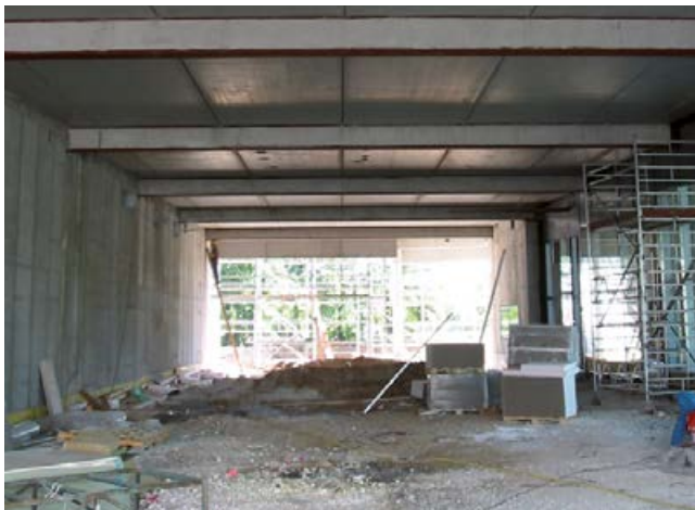
Überhöhte, vorgespannte Deckenkonstruktion, welche sich entspannt und sich im Mittelpunkt 2–4 cm absenken kann.
