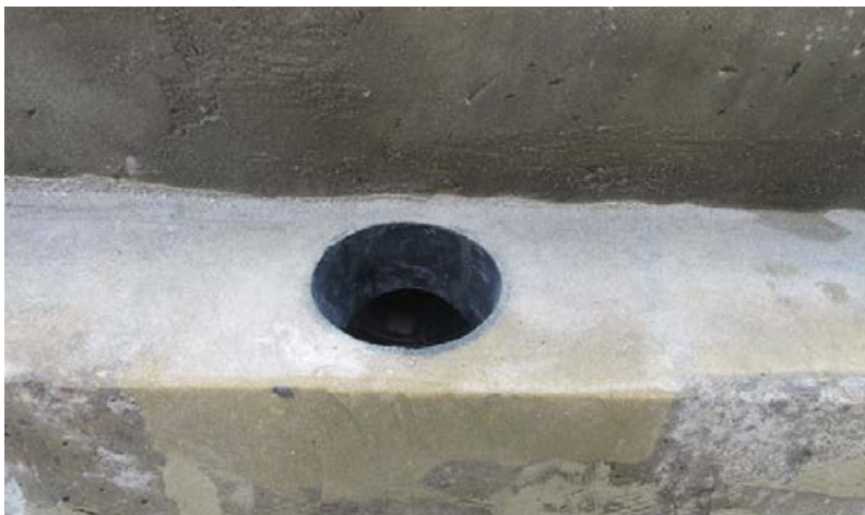
Das Durchdringungsrohr innerhalb der Rinne ist sehr gut eingebunden und bereit für den Abdichtprozess.
