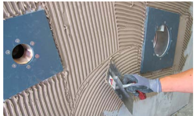
5 Aufzahn an der Betonwand mit Sopro's No.1 als Haftbrücke für den folgenden Sopro SchwimmBadPutz.
