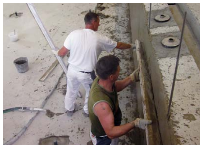
Die Wände sind mittels Sopro SchwimmBadPutz auf das notwendige Verlegemaß vorzubereiten. Der Beton wird im Vorfeld mit Sopro's No. 1 abgezahnt.
