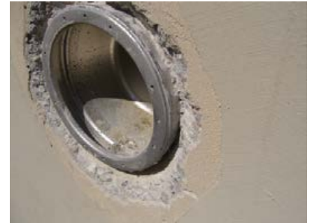
Freigestemmter Bereich am Scheinwerfer für eine kapillarbrechende Spachtelung (rohbauseitig wurde keine Vorkehrung getroffen).
