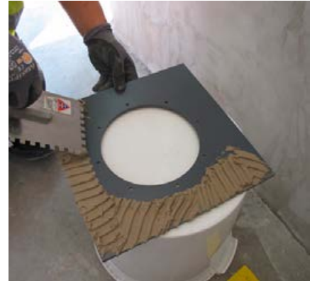
3 Rückseitiges Abspachteln der Flanschplatte mit einem Reaktionsharzmörtel (Sopro DünnbettEpoxi), um eine dauerhafte Bettung des Flansches zum Betonuntergrund zu schaffen.
