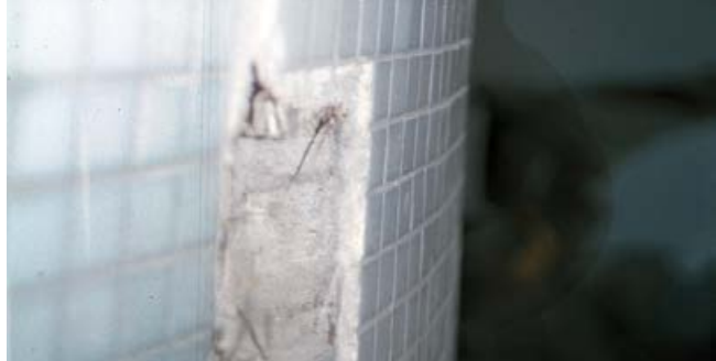
Verformte Glasmosaikwand, weil sich die Rinne vom Auflager geschoben hat.
