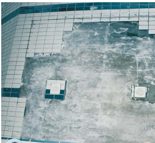
Haftverbundschaden durch Hinterwanderung der Abdichtung.
