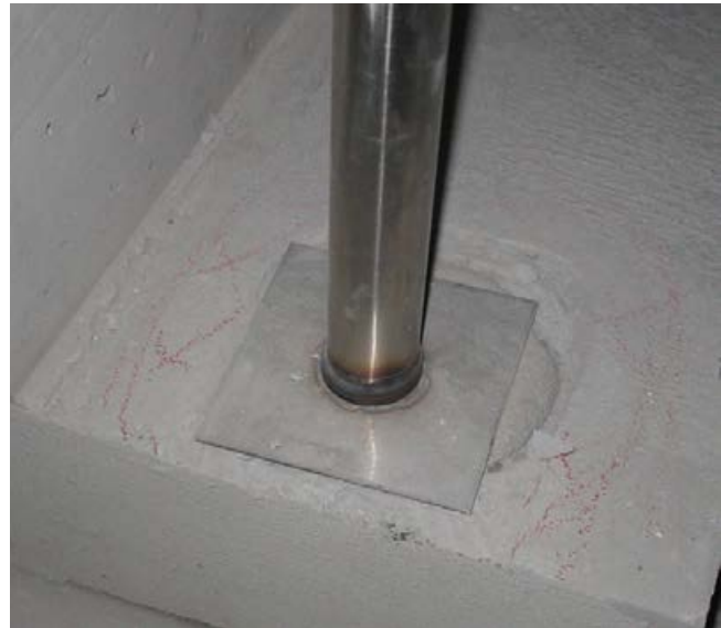
Geländerstab an Treppenstufe mit Flanschplatte.
