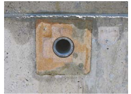
Holzplatte als Aussparung in einer Betonbeckenwand für die spätere kapillarbrechende Spachtelung oder die Montage eines Flansches.
