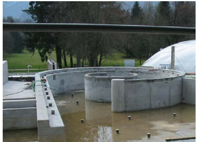
Im Betonbecken sollte kein Wasser stehen, da die Trocknung dadurch nicht stattfinden kann.
