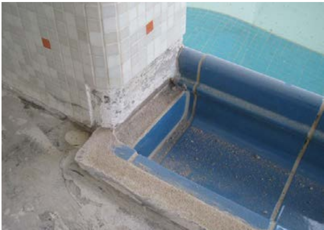
Kapillardichter Verguss am Ende einer Wiesbadener Rinne.
