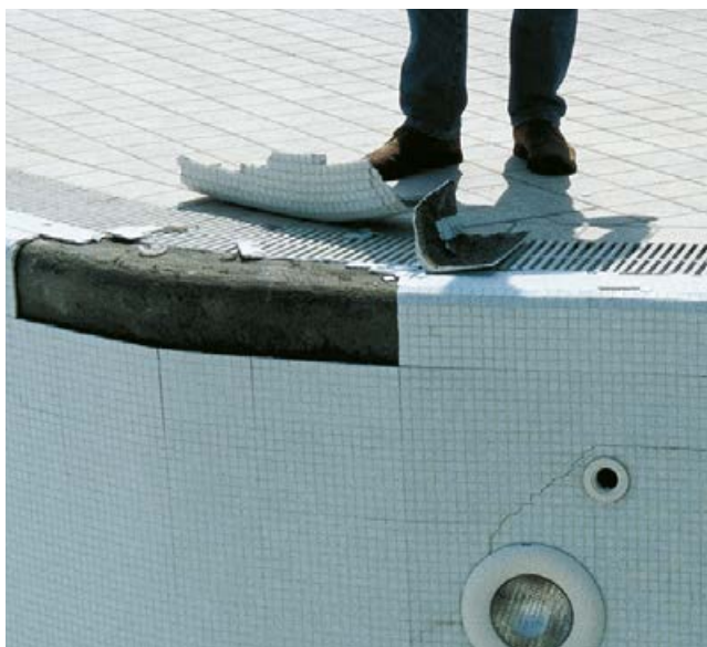
Die Ursache des Haftverbundschadens liegt im Bereich des Scheinwerfers.
