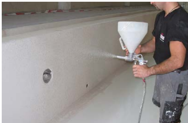
10 Abstreuen der mit Sopro PU-FlächenDicht Wand abgedichteten Fläche mit Quarzsand mittels Trichterpistole.
