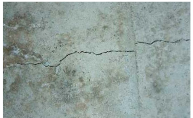
Risse im Beton sind zu bewerten und vor Beginn der weiteren Arbeiten zu sanieren.
