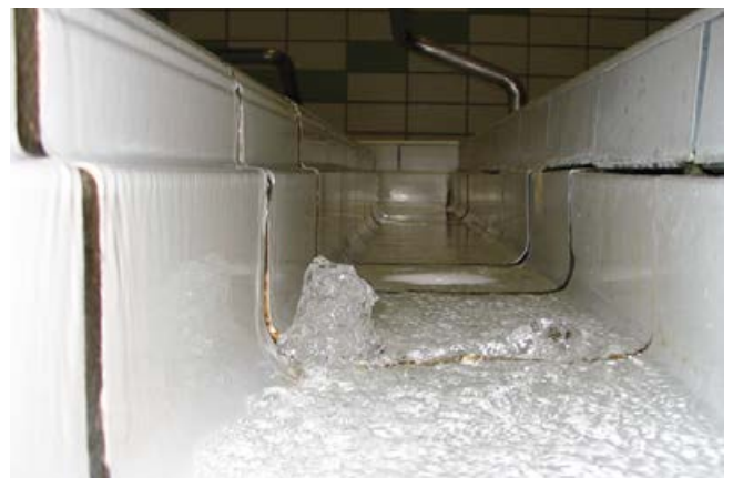
Poröser Fugenmörtel; das unter Druck stehende Wasser findet seinen Weg fontänenartig durch den Rinnenboden.
