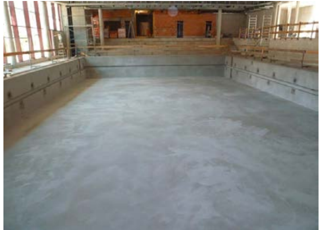
Das neue Betonbecken sollte zum Zeitpunkt der Fliesenverlegung ein Alter von 6 Monaten besitzen.
