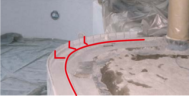
Nierenförmiges Becken mit schadhaftem Beckenkopf.
