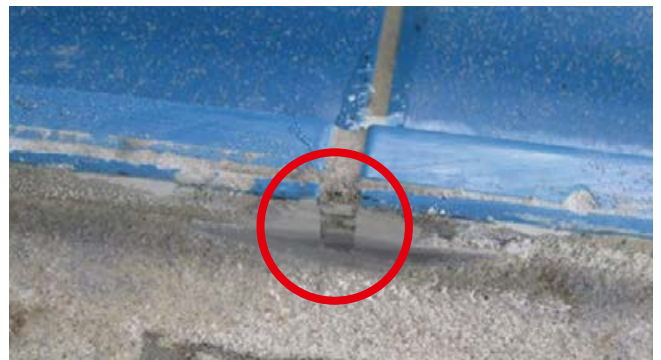
Wasseraustritt an der Verfugung des Beckenkopfsteins vor der kapillardichten Fuge.
