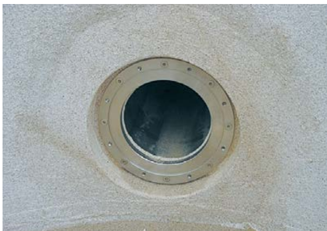
Vorbildlicher Anschluss einer Abdichtung im Verbund an ein Scheinwerfergehäuse im Unterwasserbereich mit Pressdichtflansch.
