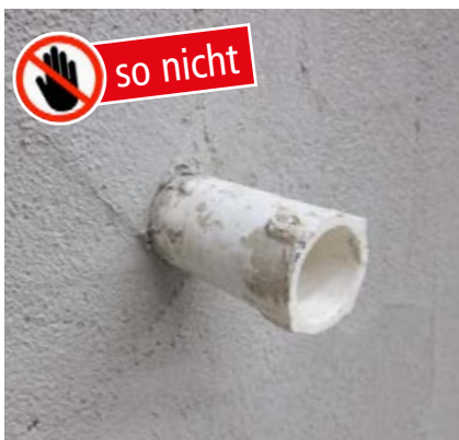
Eingeputzter Baustopfen, an welchem man nicht fachgerecht abdichten kann.
