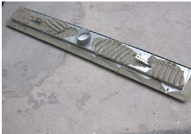
2 Die Rinne ist rückseitig mit Fliesenkleber (Sopro's No.1) für einen guten Haftverbund zum Estrich abzuspachteln.
