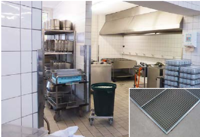
Für großvolumige Bauteile (Wagen etc.) gibt es in der Spülküche einen gesonderten Waschplatz. Dieser ist höchsten Verkehrslasten ausgesetzt. Diese Waschwannen sind ebenfalls zu untergießen.
