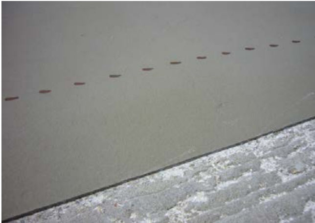
1 Die freigelegte Verbundabdichtung muss über eine Zone von ca. 10 cm verfügen, damit überlappend angearbeitet werden kann.
