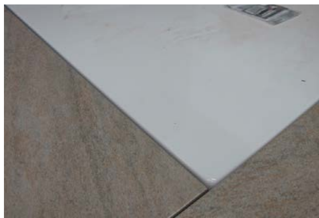
4 Gut erkennbar ist bei der Überprüfung der Höhen, dass der Fliesenbelag und die Duschfläche bündig zueinander sind.
