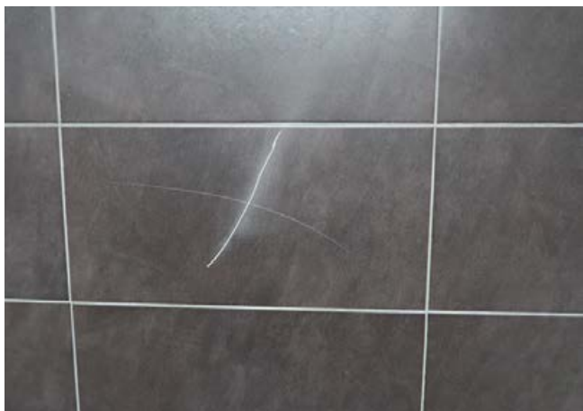
1 Wandfliese in einem Badezimmer mit einer Beschädigung.
