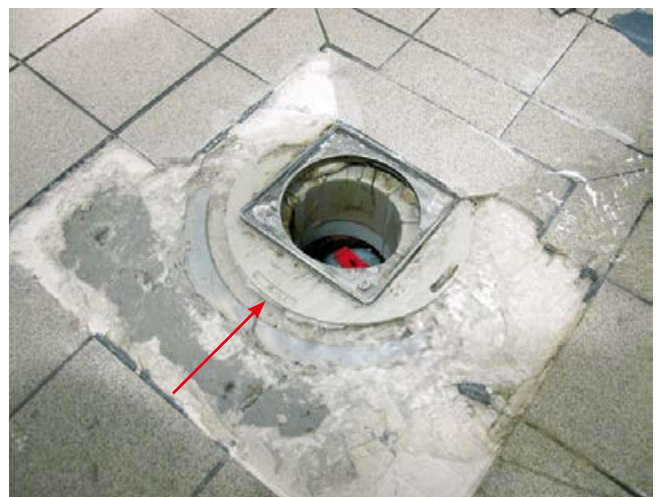
Werkseitig montierter Dichtflansch wurde, weil er störte, abgeschnitten. Die Folge: Keine Anschlussmöglichkeit für die Verbundabdichtung (Dichtungsschlämme) mehr möglich.
