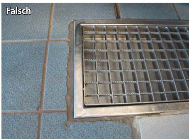
Rinne ohne Edelstahlrahmen – unsauberes Fliesenbild bzw. Kanten sind zum Teil abgebrochen.
