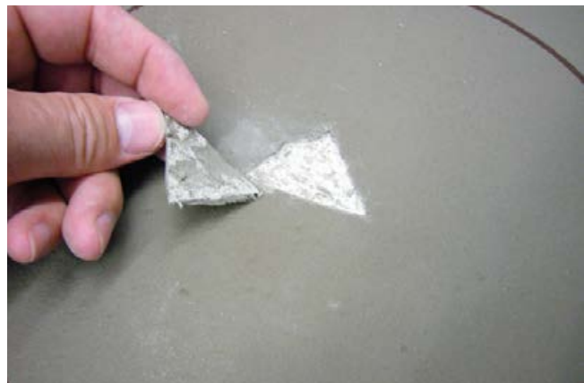
Herausgeschnittenes Abdichtungsstück zur Ermittlung der Schichtdicke.
