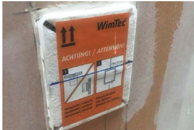
An dieser Armatur ist ein Abdichten nicht möglich. Das führt auf der Baustelle zu Problemen und ggf. auch in der späteren Nutzung.
