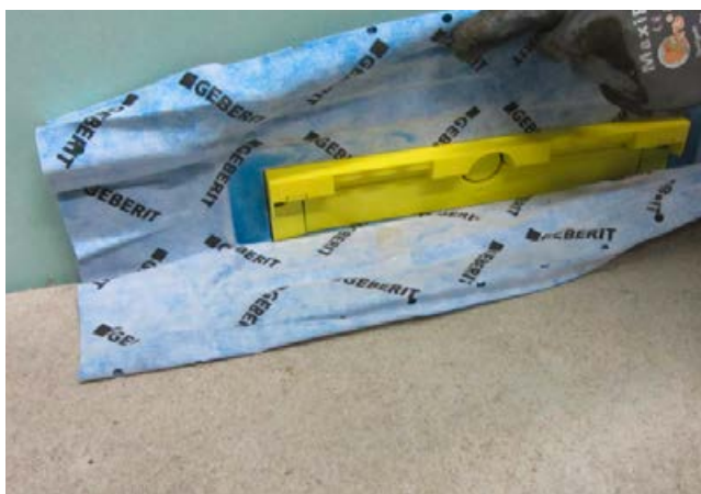
4 Die bereits am Geberit-Einlaufkörper angeschweißte Manschette wird herausgefaltet und anschließend mit der flüssig zu verarbeitenden Verbundabdichtung (Sopro TurboDichtSchlämme 2-K) verklebt und eingedichtet.
