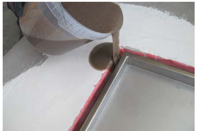
Die Harz-Sand-gebundene Mischung (1 : 1 : 1) ist so flüssig, dass ein kapillardichter Verguss an jeder Stelle der Wanne entsteht.
