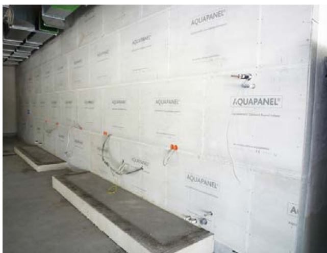
Zementgebundene Trockenbauplatten in einer Großküche.
