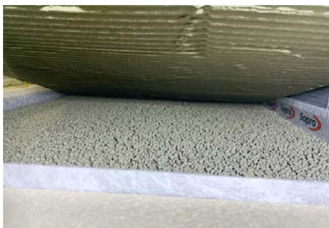
3 Setzen des Sopro ShowerBase Line Duschelements rückseitig mit Kleber abgespachtelt, auf Sopro SMART® gebundene Leichtschüttung.
