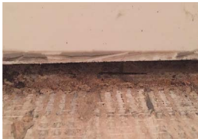
Zerschnittene Abdichtung nach Austausch der Dichtstofffugen.
