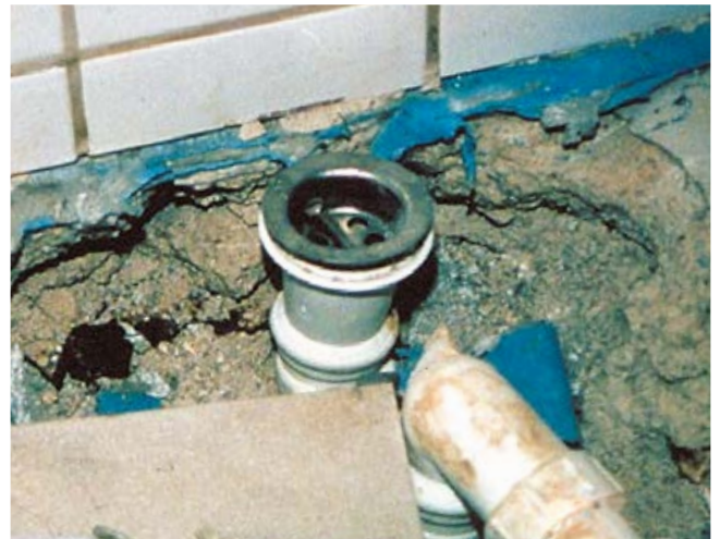
Undichtigkeit eines Tauchbeckens durch falschen Bodenablauf (Waschbeckenablauf). Flansch für den Anschluss der Abdichtung fehlt.
