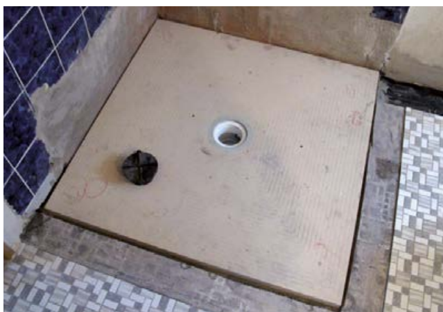
4 Eingesetztes Duschelement, bereit für die Abdichtungsarbeiten. Das Element selbst ist nicht dicht und muss deshalb komplett mit eingedichtet werden.
