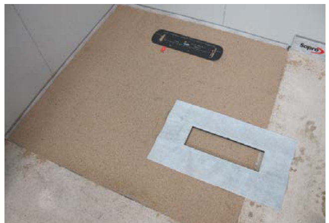
6 Fertig hergestellte Fläche, bereit für die folgenden Abdichtarbeiten. Hierzu wird die bereitliegende Manschette in eine Nut des Bodenablaufgehäuses eingedrückt und anschließend in die Dichtschlammab-dichtung eingearbeitet.
