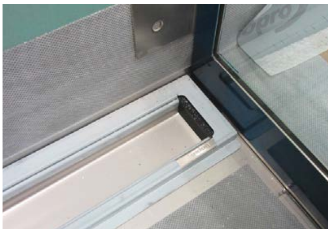
3 Das Detail Rinnenende mit Glasscheibenverwahrung ist gut gelöst.
