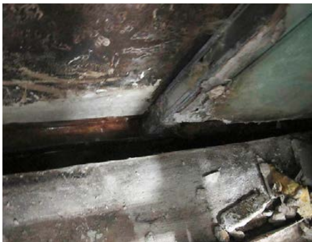
Wasserschaden mit anschließendem Schimmelbefall in einer Trockenbaukonstruktion mit Gipskarton.
