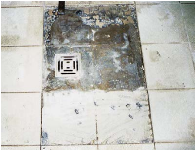
Fehlende Anschlussmöglichkeit für die Verbundabdichtung an den Bodenablauf.
