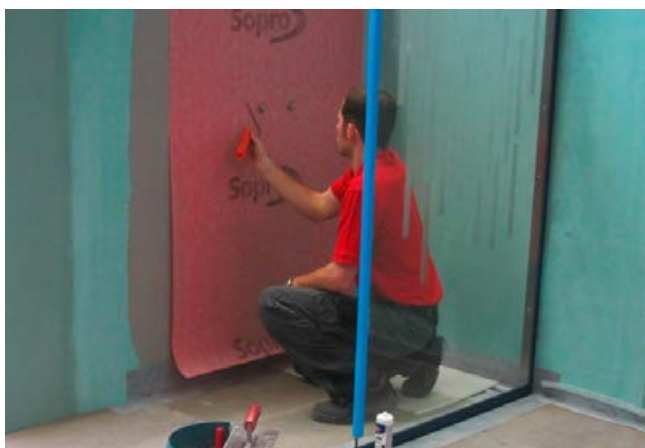
5 Die Abdichtung der Wandfläche erfolgt mit Sopro AEB® Abdichtungs- und Entkopplungsbahn. Diese wird mit Sopro's No.1 verklebt.
