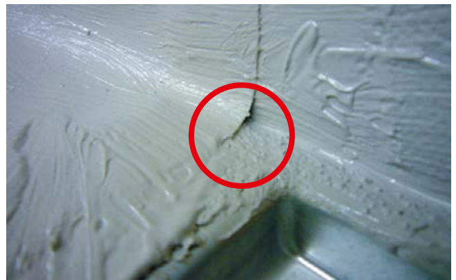
Eine Kanalbildung ist trotz Abdichtarbeit zu erkennen.
