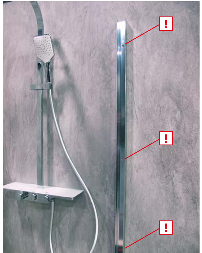
Für die Montage der Türen ist es notwendig, Löcher in die Fliesen zu bohren. Beim Duschen kann Wasser oder auch Kondensat in die Türprofile gelangen. D.h., auch die Bohrlöcher werden mit Feuchte konfrontiert.
