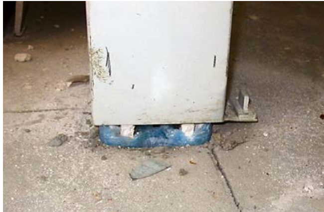
Ein Abdichten der Trockenbauwand ist im Türbereich nicht mehr fachgerecht möglich.
