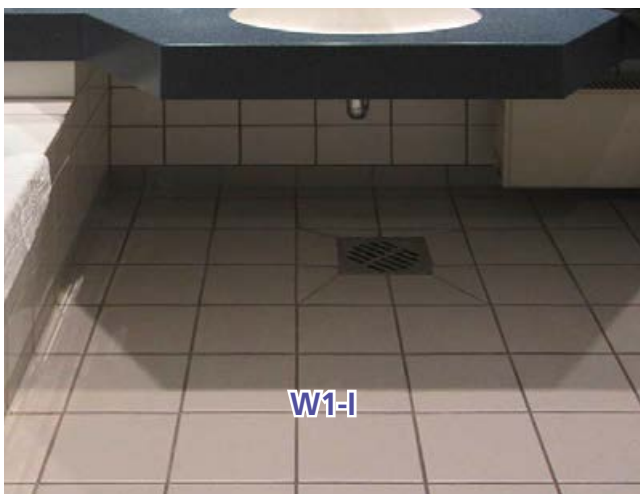
Badezimmer mit Bodenablauf vor der Badewanne, unterhalb eines Waschbeckens.
