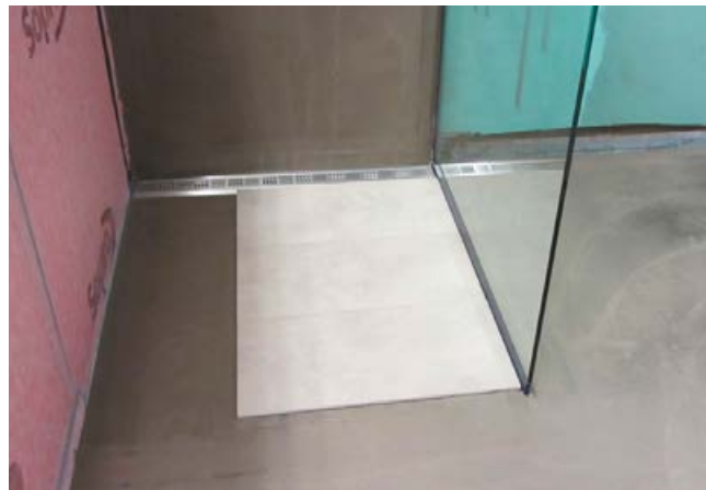
6 Die Abdichtung des Bodens erfolgte mit Sopro TurboDicht-Schlämme 2-K. Zur Bewertung der Einteilung der Fliesen sind bereits einige Fliesen in der Duschfläche ausgelegt.
