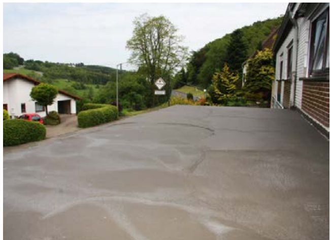
Terrasse/Balkon abgedichtet mit einer zementären, flexiblen Dichtschlämme (z. B. Sopro TurboDichtSchlämme 2-K), bereit für die folgende Fliesenverlegung.
