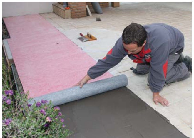
4 Verlegen der AEB® plus Abdichtungs- und Entkopplungsbahn plus in das vorbereitete Mörtelbett.
