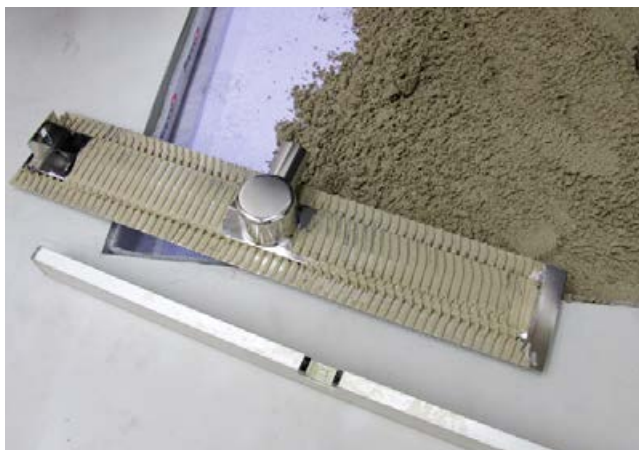
2 Die mit Fliesenkleber (Sopro's No.1 als Haftbrücke) rückseitig abgepackelte ACO-Rinne wird in den frischen Estrichmörtel (Sopro Rapidur® M1/Sopro Rapidur® M5) eingearbeitet.
