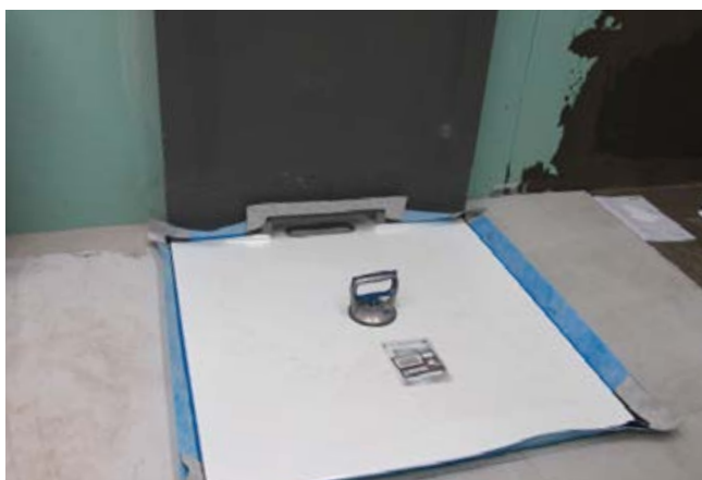
3 Die Duschfläche ist im Estrich oberkantenbündig zum angrenzenden Fliesenbelag versetzt. Die Entwässerung ist in die Wand verlagert. Ein Schedel-Wandelement kann hier hilfreich sein.
