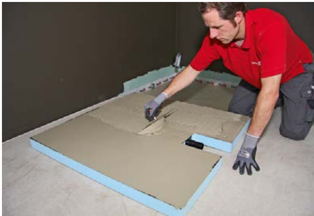
3 Auf der Rückseite des Duschelementes wird Fliesenkleber (Sopro's No.1) für die Verklebung zum Untergrund aufgetragen. Der Untergrund wird ebenfalls mit Fliesenkleber abspachtelt.
