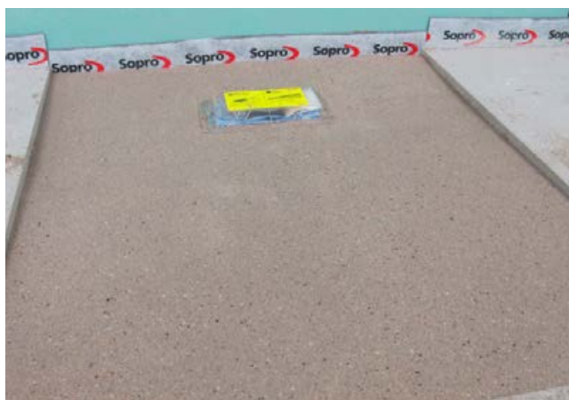
6 Duschfläche hergestellt mit harzgebundenem Estrichmörtel, bereit für die folgenden Abdicht- und Fliesenarbeiten.
