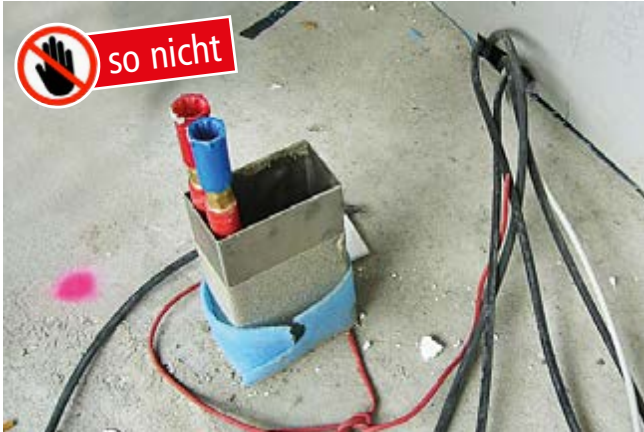
So nicht: Eine Leitung kommt unkontrolliert aus dem Estrich bzw. der Wand.
