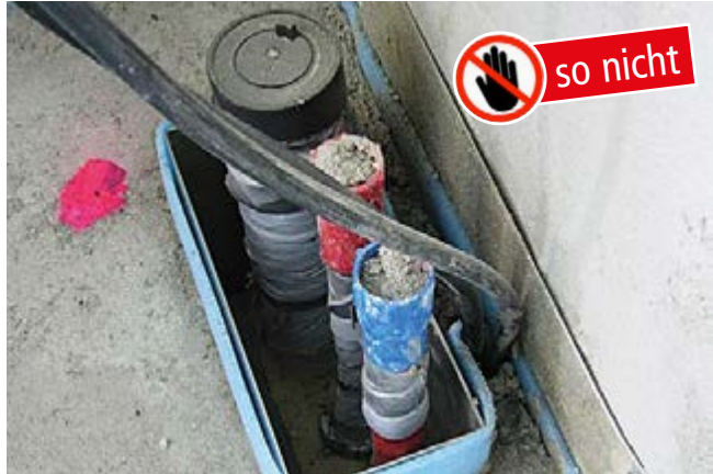
So nicht: Aufgrund des nicht vorhandenen Platzes ist auch kein fachgerechtes Eindichten möglich.
