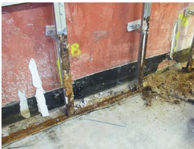
Zerstörung der Trockenbaukonstruktion, verursacht durch eingewandertes Wasser.
