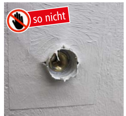
Nach dem Herausschrauben des Baustopfens für die folgende Installation hat die Dichtmanschette ihre abdichtende Wirkung völlig verloren.
