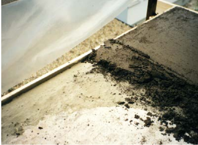
1 Aufbringen des Gefällepachtels (Sopro RAM 3® oder Sopro Rapidur® M5 SchnellEstrichMörtel) bzw. Verbundestrichs „frisch-in-frisch“ mit Haftbrücke.
