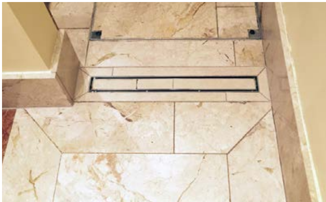
Rinne im Bereich des Durchganges.
