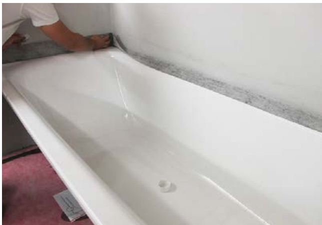
1 Wanne mit angeklebtem Dichtband (System Franz Kaldewei GmbH & Co. KG) bereits an der Wand angestellt.
