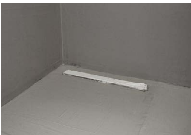
6 Komplet abgedichtete Duschecke in zwei Arbeitsgängen (Wand- und Bodenfläche) mit Sopro DichtSchlämme Flex RS, bereit für die folgende Fliesenverlegung.
