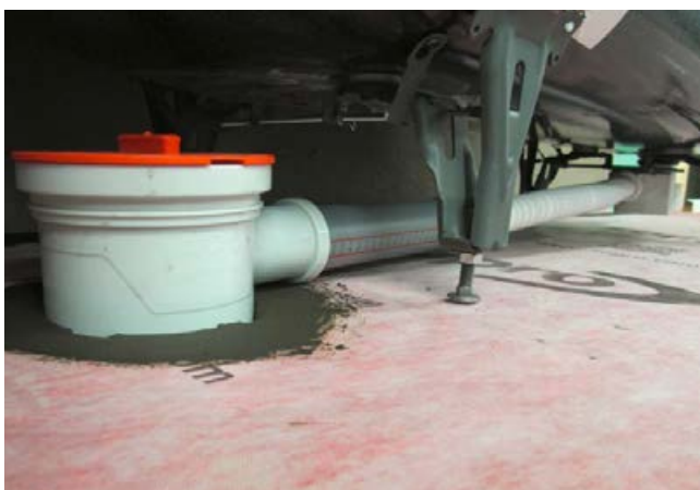
7 Das Badewannenabwasser fließt über die Zwischenentwässerung problemlos ab. Gleichzeitig kann das anfallende Wasser bei einer Undichtigkeit auf der Abdichtung ebenfalls abfließen.
