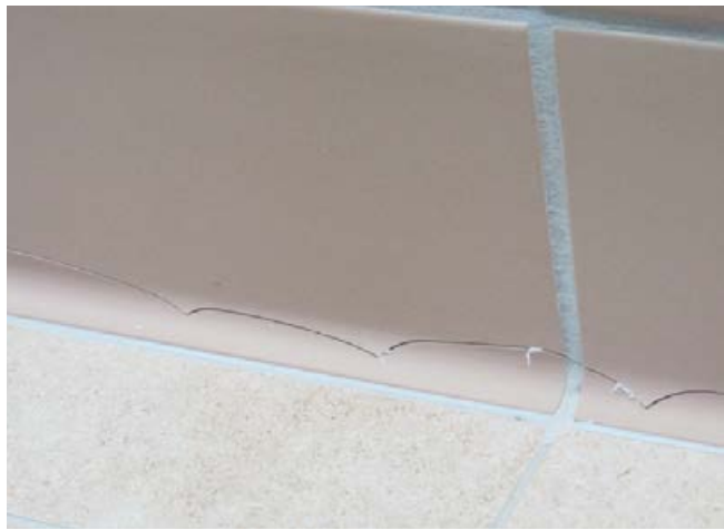
Hohlkehlsoclelfliese mit dem langen Schenkel an der Wand verlegt, führt schnell zu Brüchen im unteren Bereich der Fliese.
