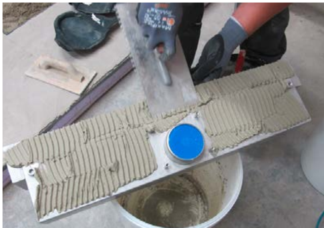
2 Abspachteln der Rinnenrückseite mit Fliesenkleber (Sopro's No.1) zur Herstellung eines guten Haftverbundes zum Estrichmörtel.
