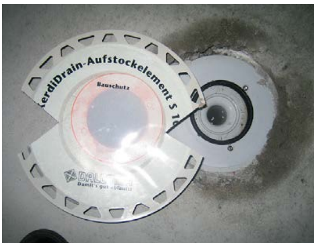
Aufstockelement mit breitem Klebeflansch für die Verbundabdichtung wurde zur einfacheren Montage (Verguss) aus Gedankenlosigkeit zerstört.
