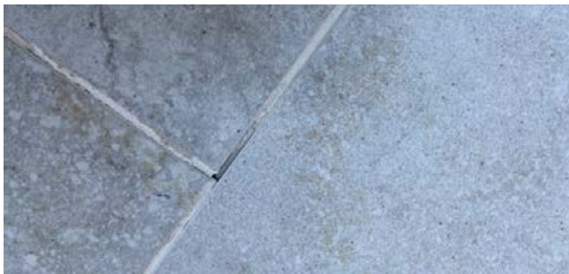
Gerissene zementäre Fugen bei einem labilen Untergrund, hier kann die Sopro DFH DesignFugeHybrid als Lösung eingesetzt werden.
