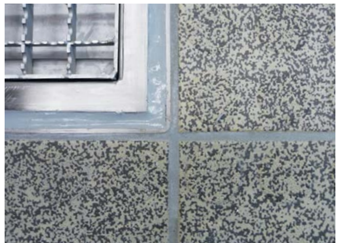
Hochbelastete Dichtstofffuge im Bereich einer Großküchenrinne.
